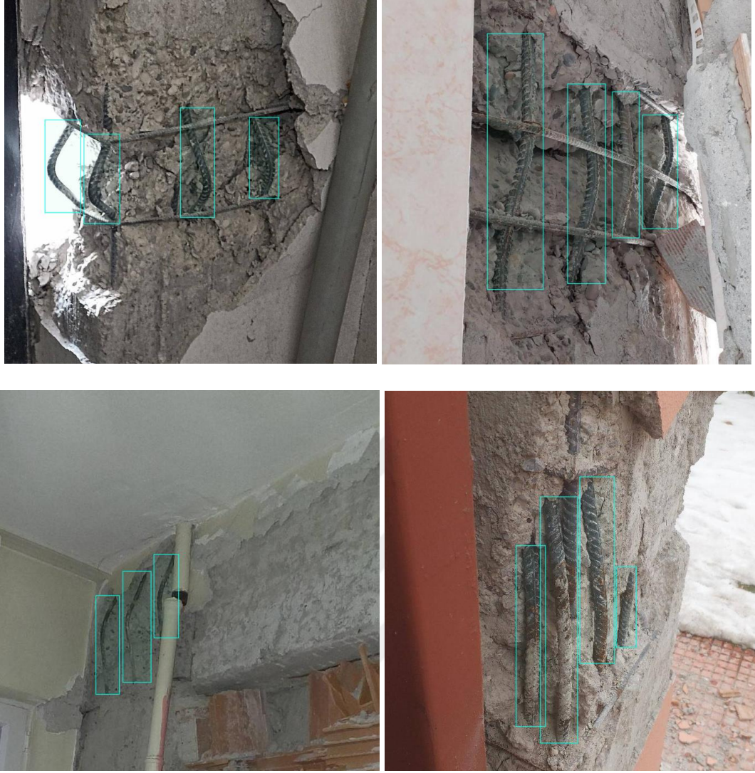
Şekil 3.2 : Donatı burkulmalarının etiketlenmesi.
