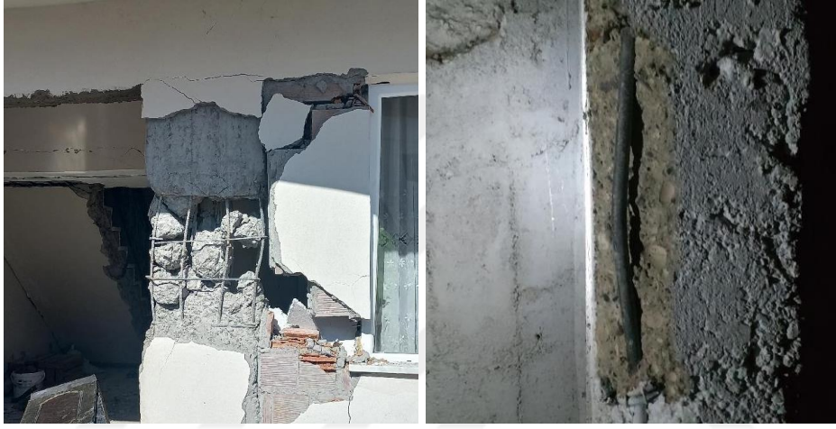
Şekil 3.3 : Farklı ışık koşullarında burkulma hasarı fotoğrafları.
