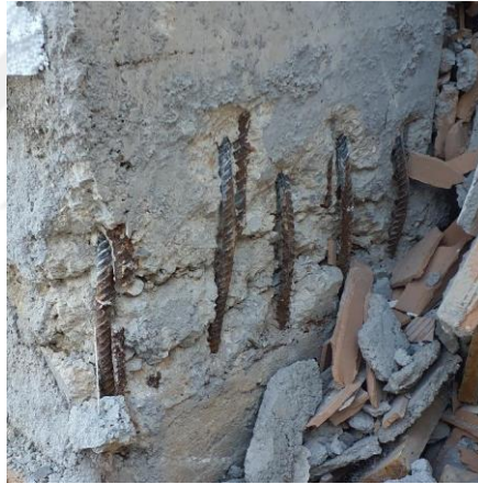
(c) Korozyon başlangıcı görülen yapısal çelik
