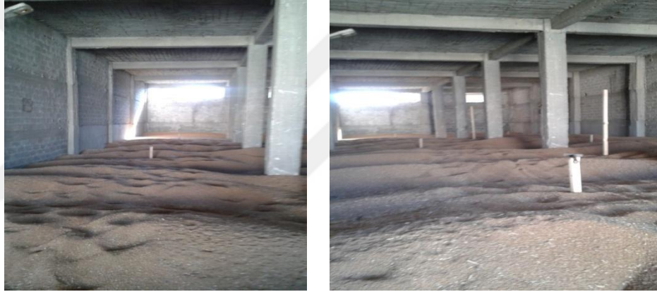
Şekil 3.4. Depoda Havalandırma Sistemi
