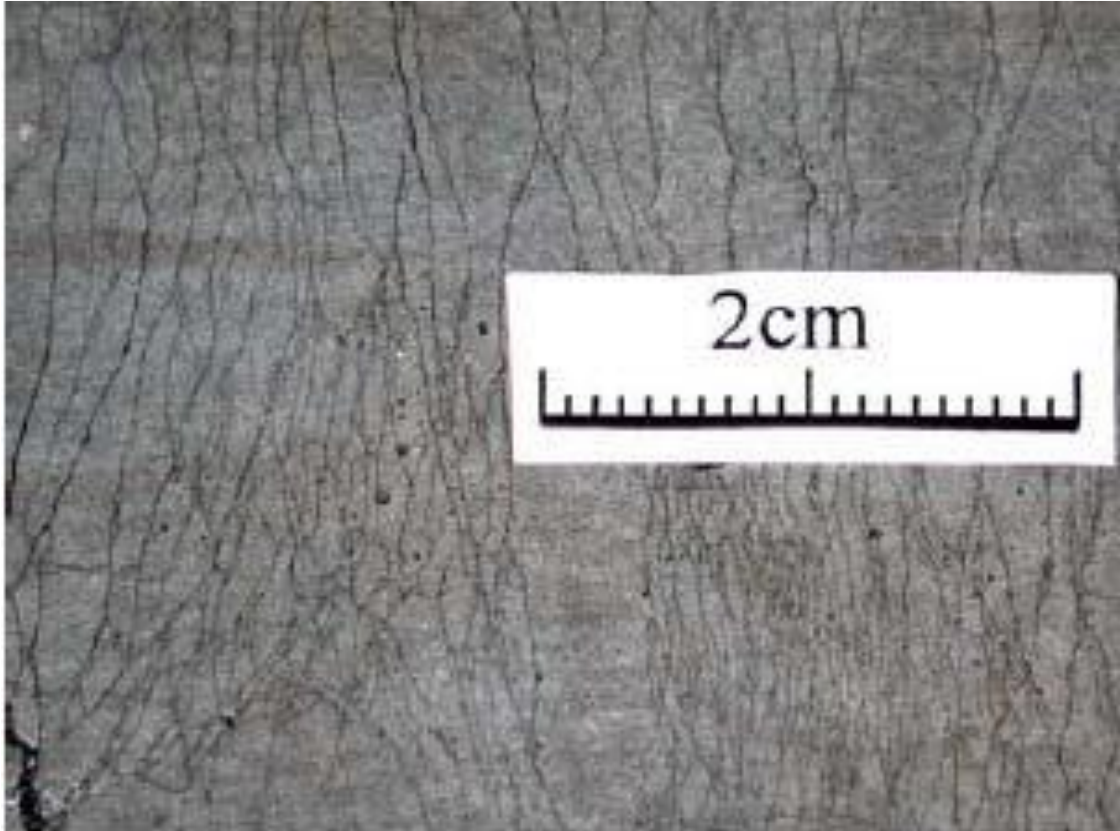
Fotoğraf 2.1. Lifli çimento esaslı kompozitte oluşan paralel çatlaklar (Boğazkesen, 2011)
