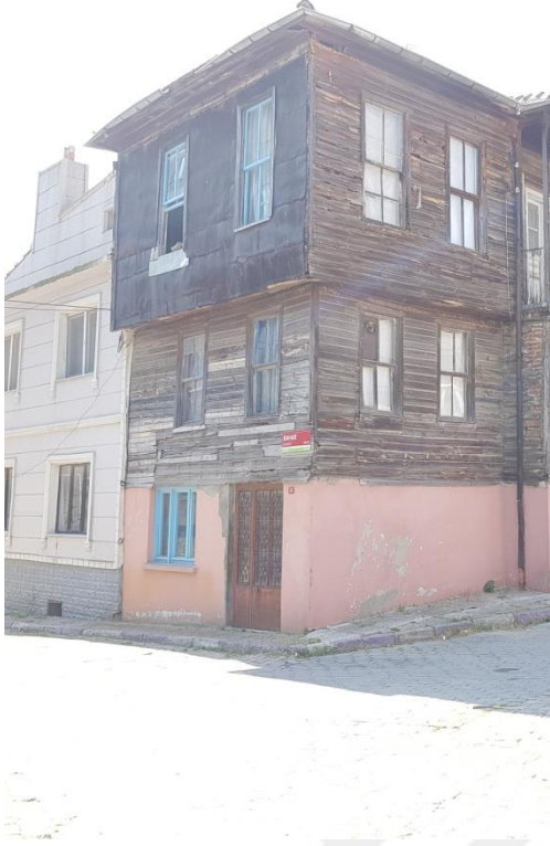
Resim 4.143. Zemin kat taş duvar üzeri sıvada oluşan deformasyon
