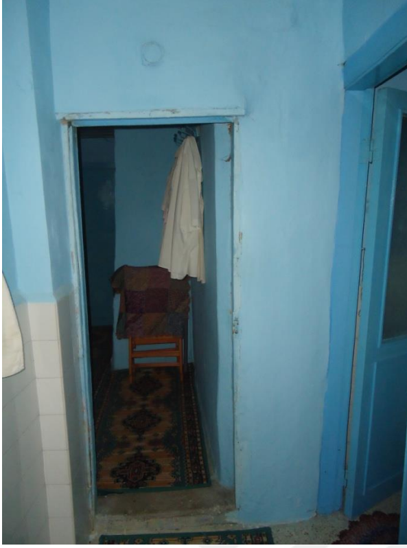
Resim 4.86. 105 Lavabo kapı boşluğu
