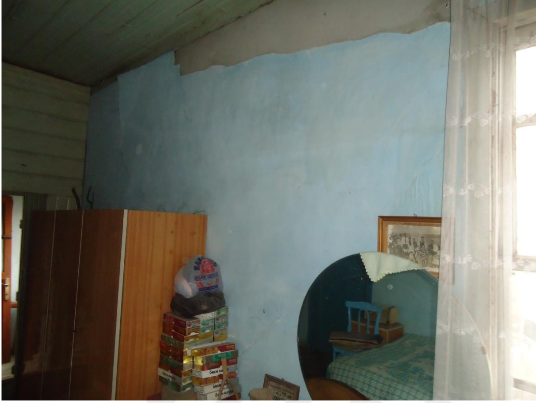
Resim 4.115. 204 Oda güney duvardaki deformasyonlar
