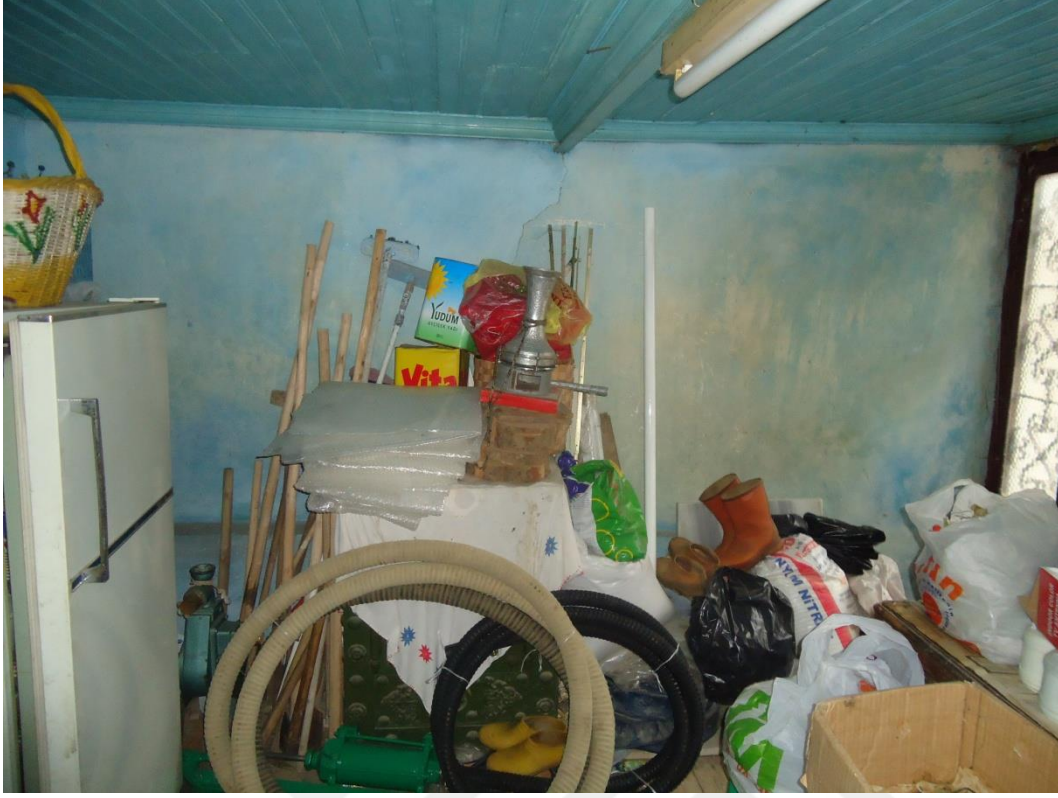
Resim 4.35. Z04 Depo batı duvarında oluşan deformasyonlar
