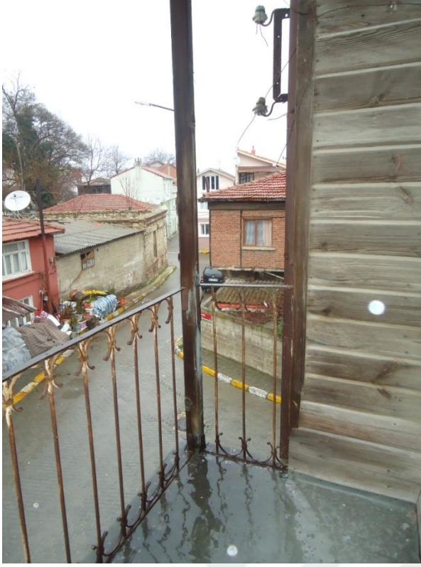
Resim 4.8. Balkon kenarlarındaki ferforje korluluk
