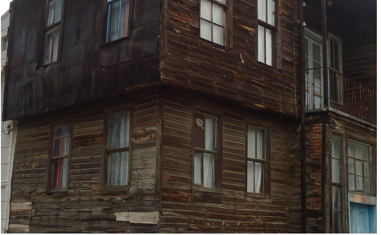
Resim 4.122. Ahşap dış cephe kaplamalarında oluşan deformasyon
