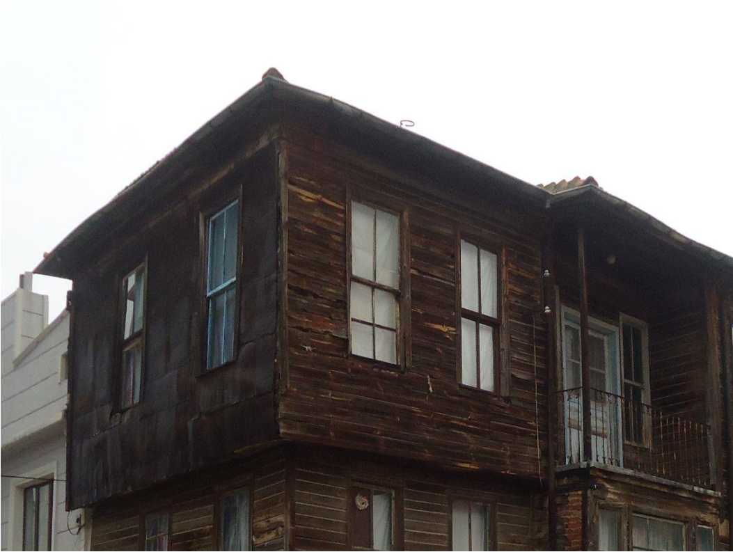
Resim 4.125. Alın tahtası ve yağmur oluklarında oluşan deformasyonlar
