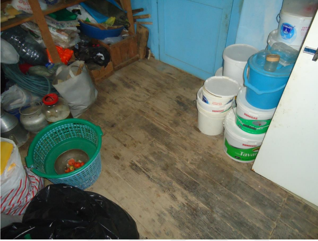
Resim 4.123. Ahşap zemin yüzeyinde oluşan aşınma
