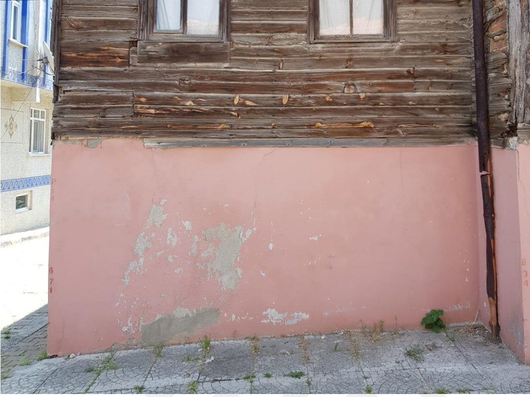
Resim 4.120. Zemin kat taş duvarda meydana gelen deformasyonlar
