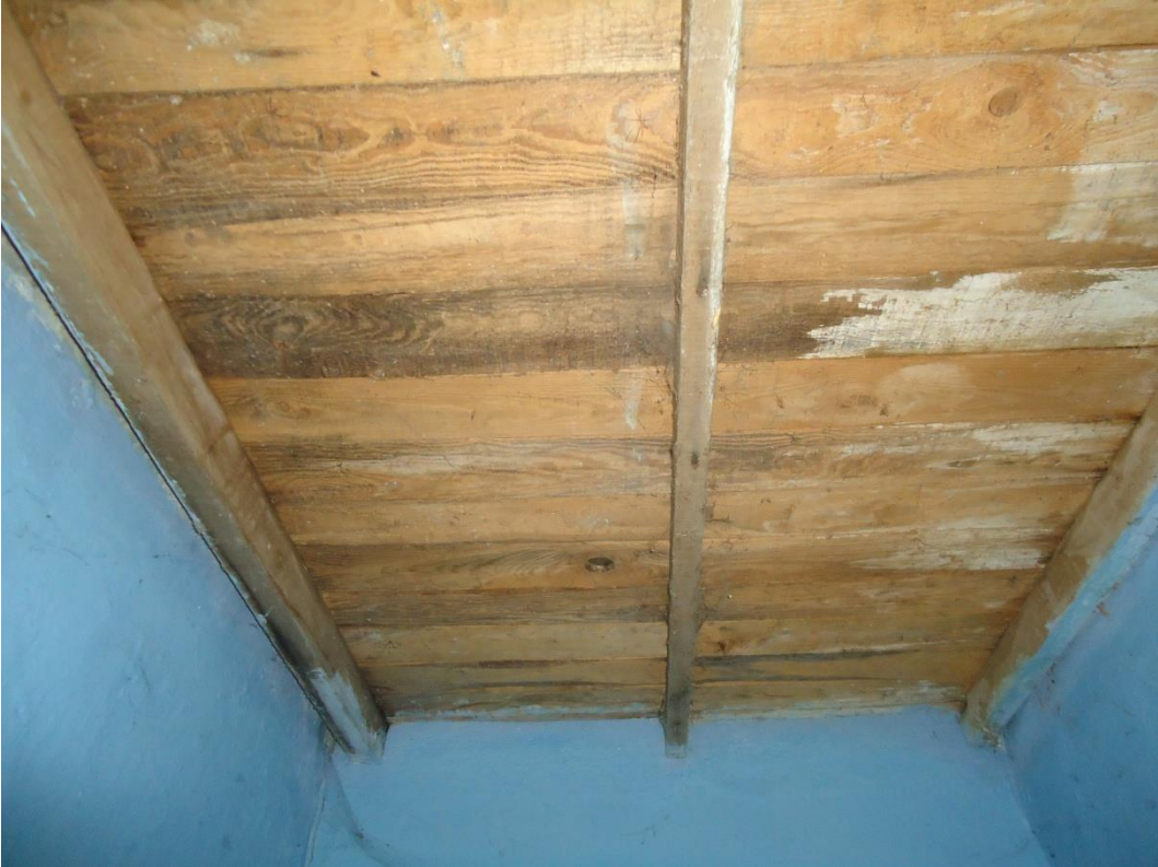
Resim 4.51. Z07 Wc tavan kaplaması
