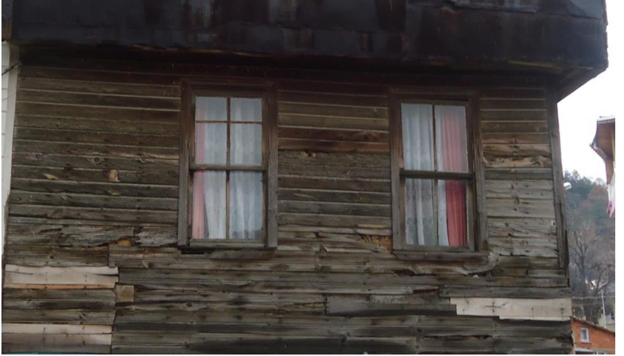
Resim 4.16. Ahşap cephe kaplamalarında meydana gelen deformasyon
