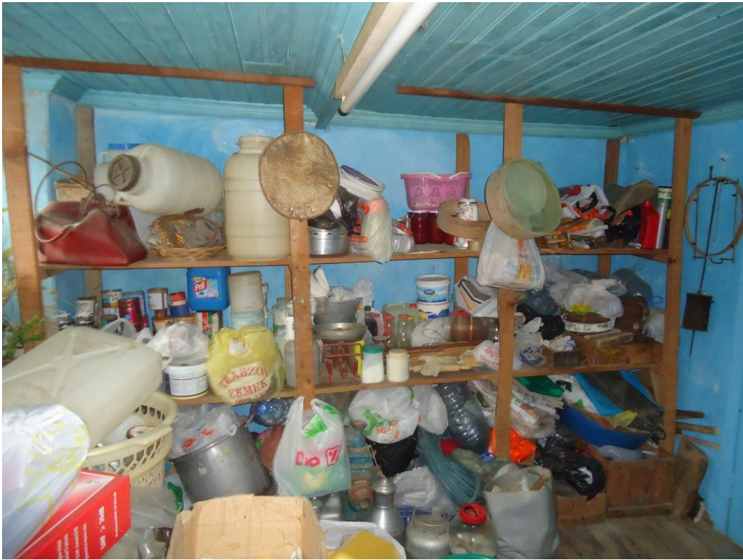
Resim 4.36. Z04 Depo dođu duvarında oluşan deformasyonlar
