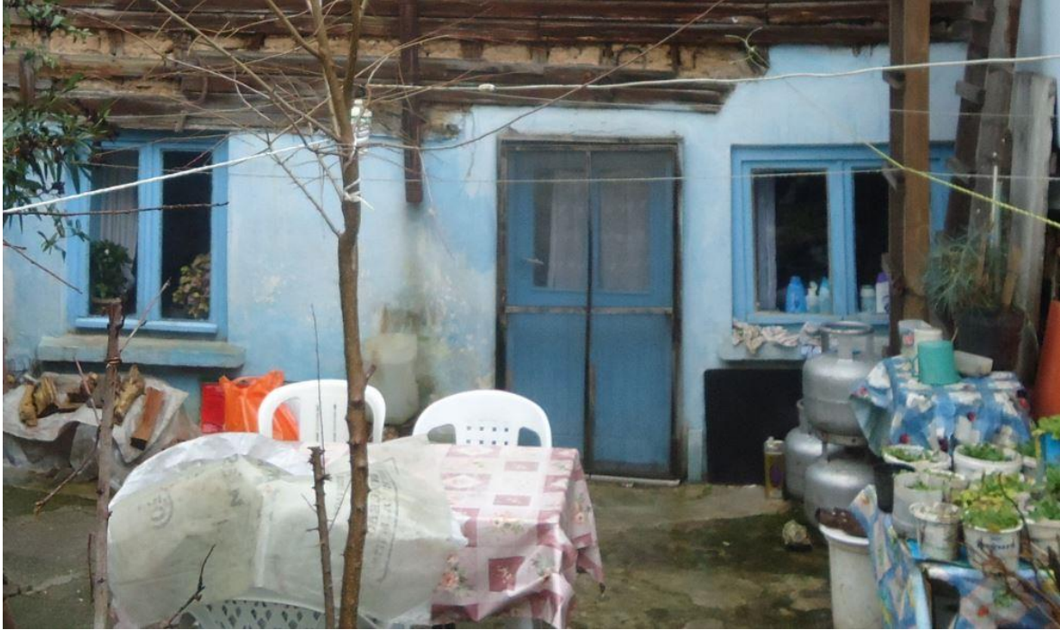
Resim 4.130. Gney cephe, niteliksiz onarım ile deęişen pencereler
