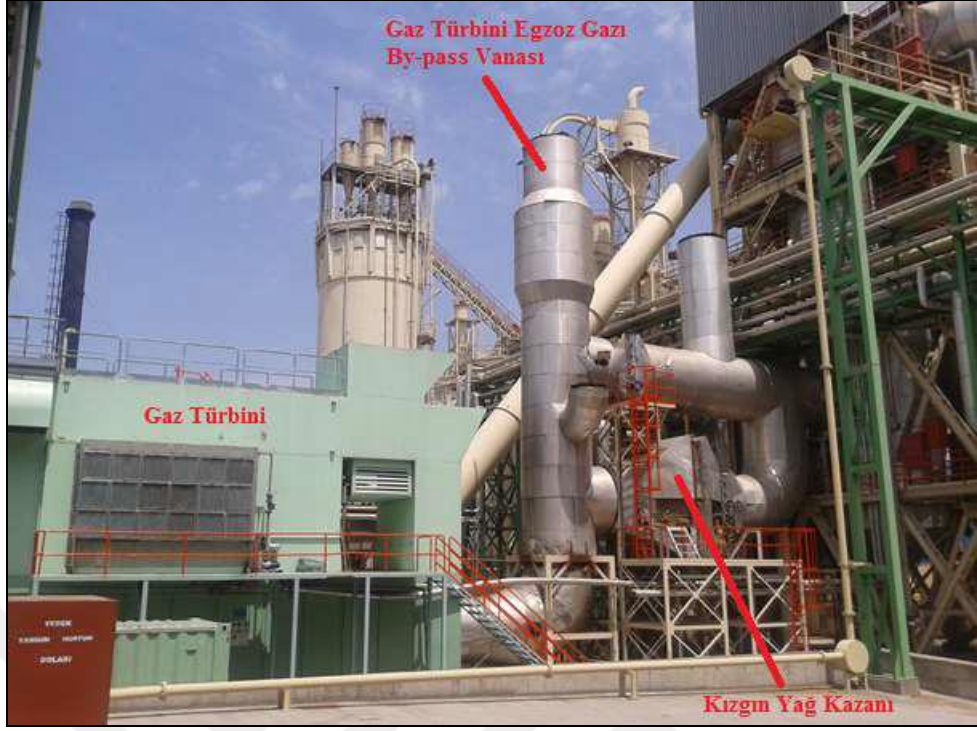
Şekil 3.3. Gaz türbini, kızgın yağ kazanı ve by-pass hattı
