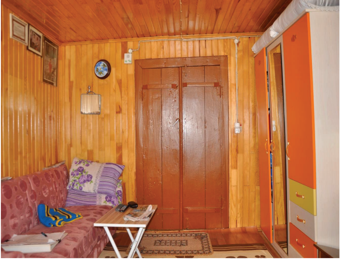
Resim 4.109. 1K03 mahali DV1 duvarı
