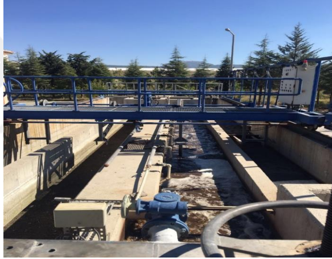
Şekil 0.2. Kum ve yağ tutucu ünitesi
