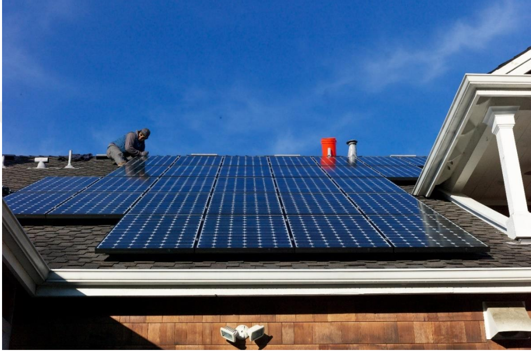
Şekil 1.1 Çatıya monte edilmiş güneş panelleri[14]
