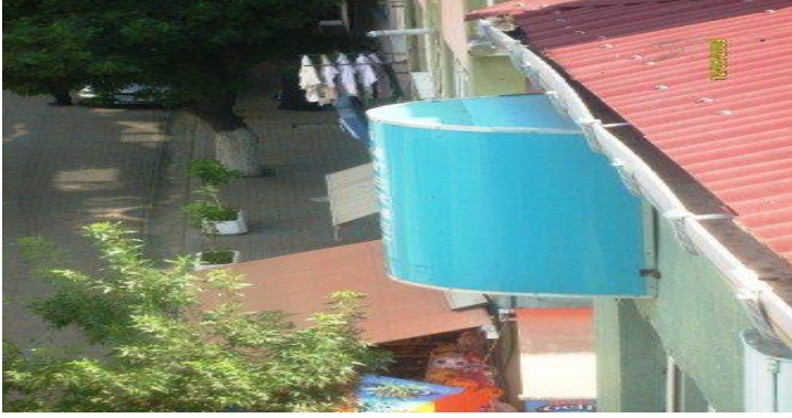
Şekil 11. Bina duvarına yapılmış baz istasyonu (URL-7)
