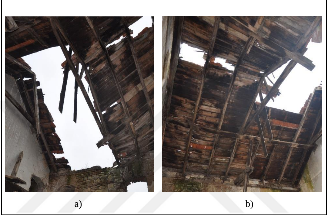
Şekil 4.56: a) Çöken çatının doğu yönü, b) Çöken çatının batı yönü.
