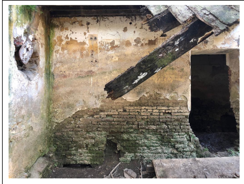
Şekil 4.53: Yapının iç duvarlarındaki küf, mantar ve yosun oluşumu.
