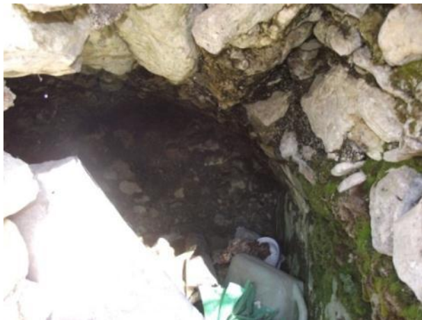
Şekil 7.24. Yeşil Ada Hamamı'nın içi çöp dolu M5 nolu soğuk su deposu
