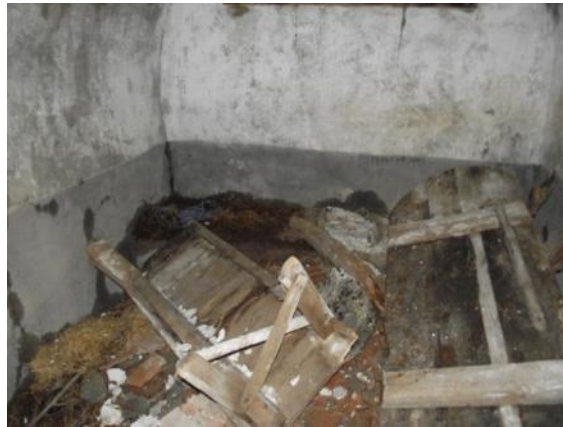
Şekil 7.17. Yeşil Ada Hamamı'nın sıcaklık bölümündeki üzeri çöp yığını dolu, batı duvarı sekisi
