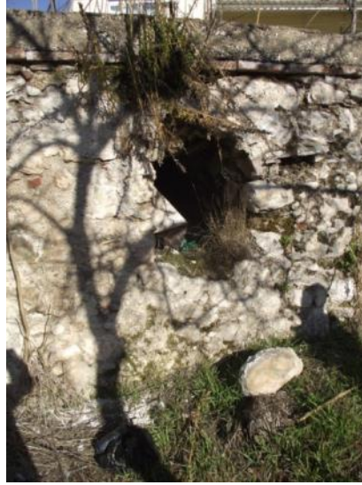
Şekil 7.23. Yeşil Ada Hamamı'nın M5 nolu soğuk su deposuna açılan boşluk
