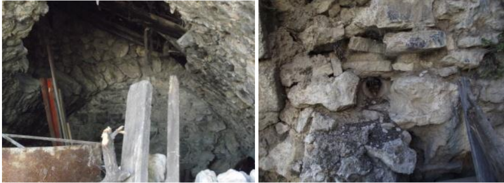
Kaleburnu hamamı kalıntısına ait üst örtü ve tesisat kalıntısı
