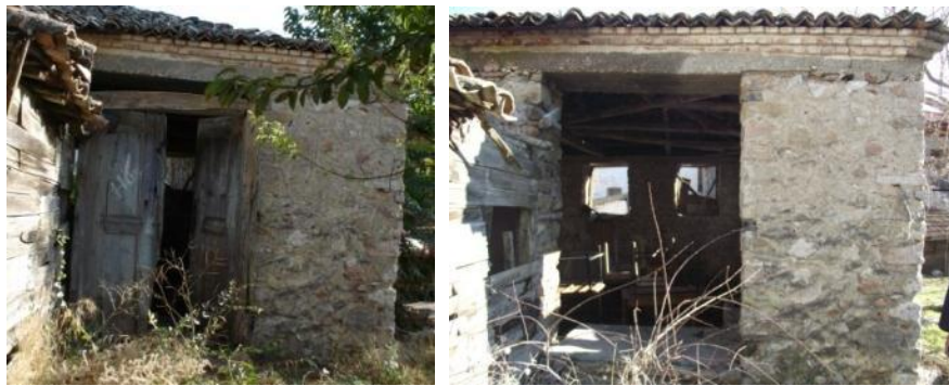
Şekil 7.10. Yeşil Ada Hamamı'nın günümüzde sökülen giriş kapısı
