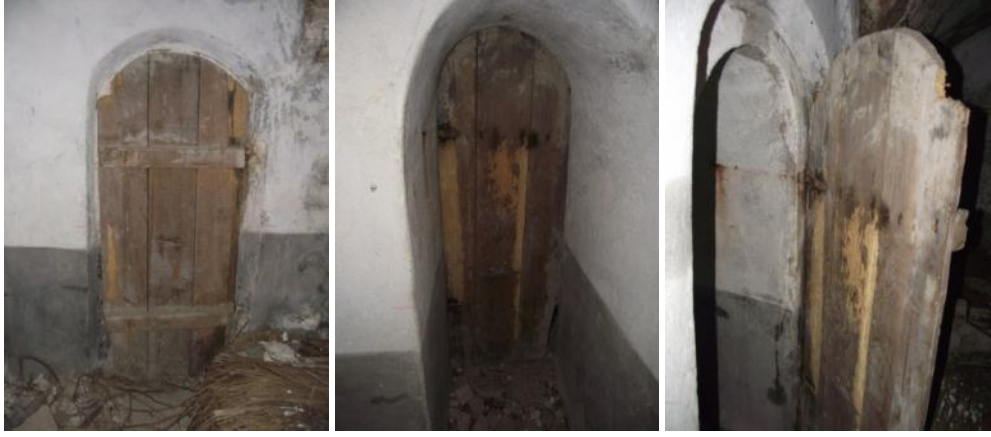
Şekil 7.51. Yeşil Ada Hamamı'nın M4 nolu halvete ait özgün kapının sıcaklıktan ve halvetten görünümü
