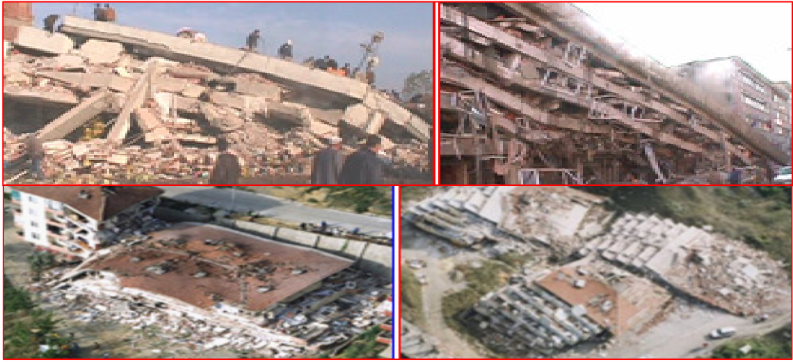
Şekil 3.10. Düğüm noktası hasarları
