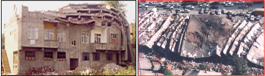
Şekil 3.7. Kolonların yetersiz olmasından oluşan Marmara depremi hasarları
