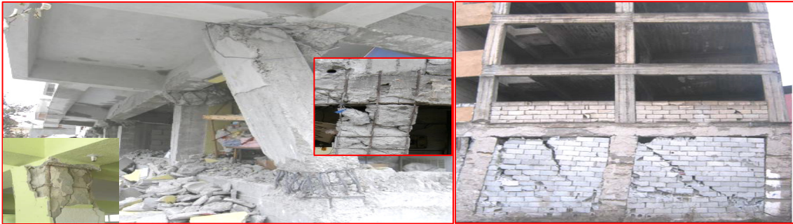
Şekil 5.1. Düğüm noktası deprem hasarları
