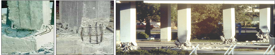
Şekil 3.8. Kolon deprem hasarı
