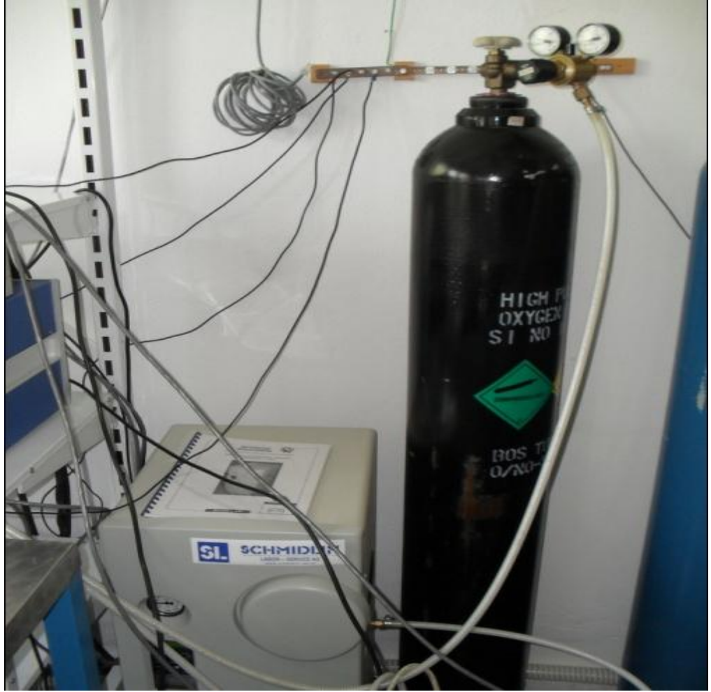
Şekil 3.54. Azot jeneratörü ve oksijen tüpünün görüntüsü
