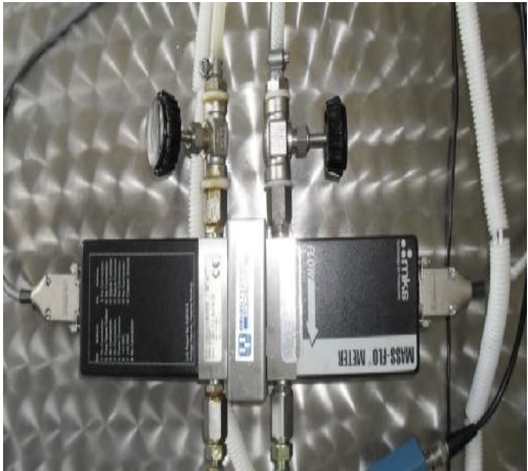
Şekil 3.53. Gaz akış basınç kontrol sisteminin görüntüsü
