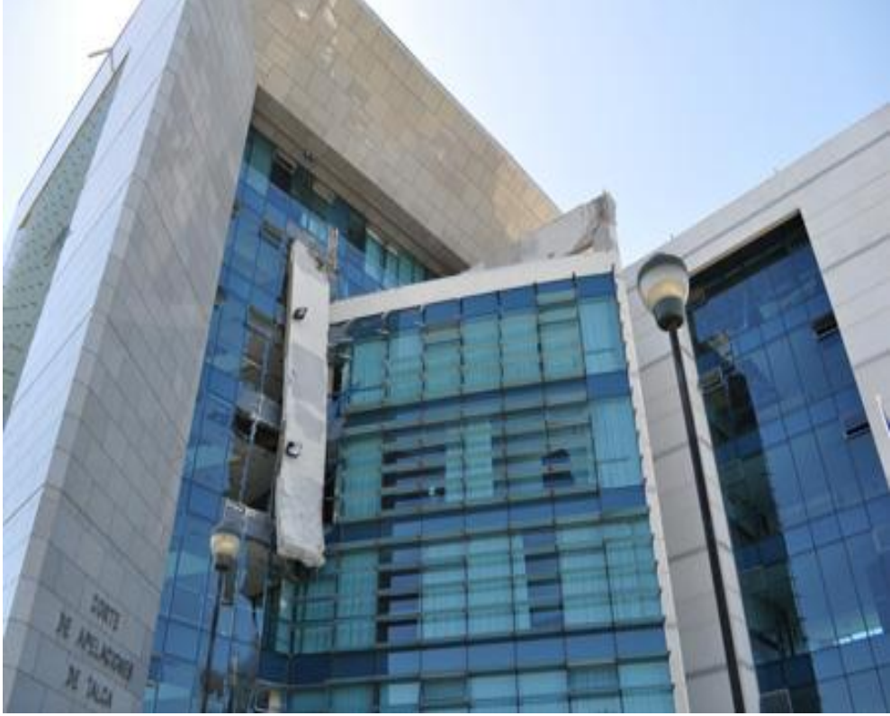
Şekil 1.3: Giydirme cephe sistemindeki hasar-1, 2010 Chile Depremi.
