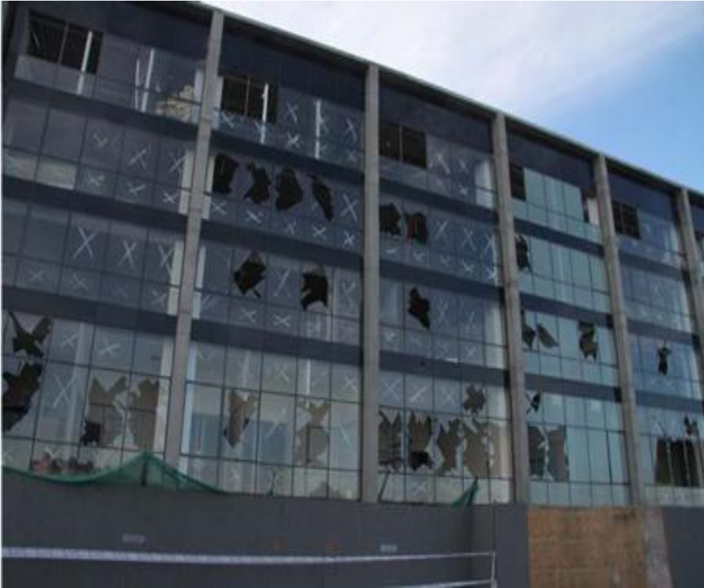
Şekil 1.4: Giydirme cephe sistemi cam hasarı-2, 2010 Chile Depremi.
