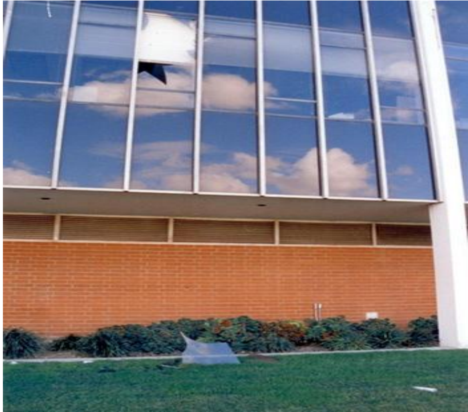
Şekil 1.2: Cephe sisteminden ayrılan parçalar, 1994 Northridge Depremi.
