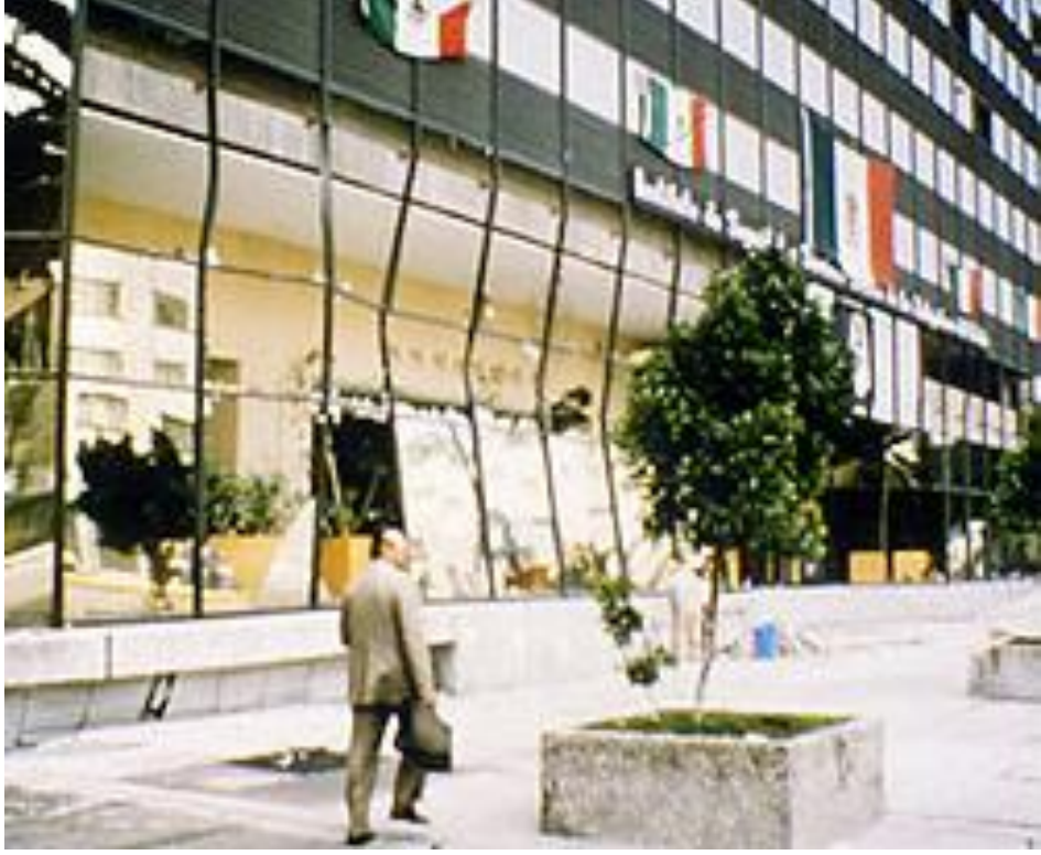
Şekil 1.1: Giydirme cephe sistemindeki hasar, 1985 Meksico City Depremi.
