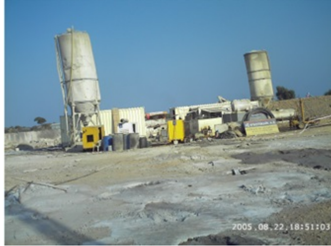
Şekil 2. 5. Jet grout çimento silosu, pompa ve santral üniteleri (Bakım, 2007)
