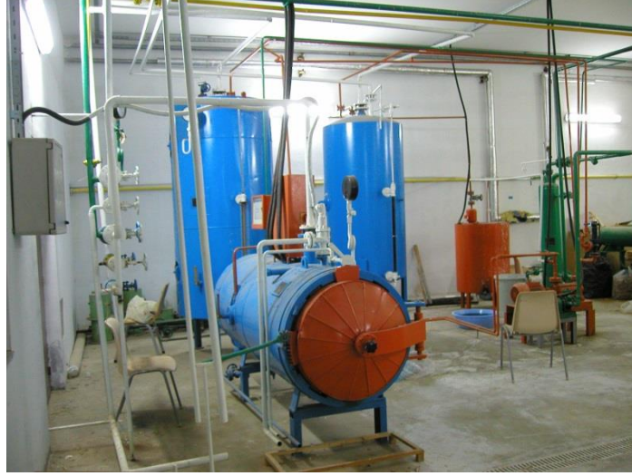
Şekil 3.3. Kastamonu Üniversitesi Emprenye Pilot Tesisi
