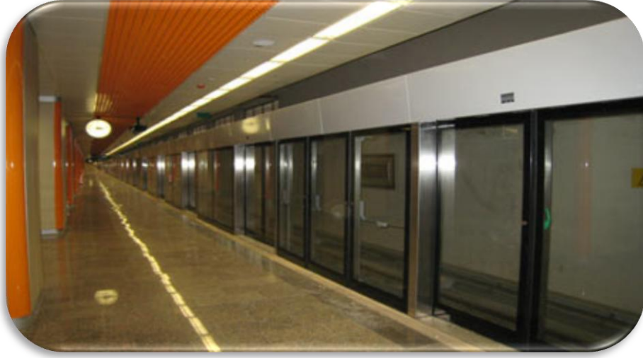
Şekil 1.1 : Metro istasyonlarında bulunan peron ayırıcı kapı
