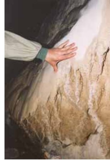
Aşınmış duvar akma taşları
