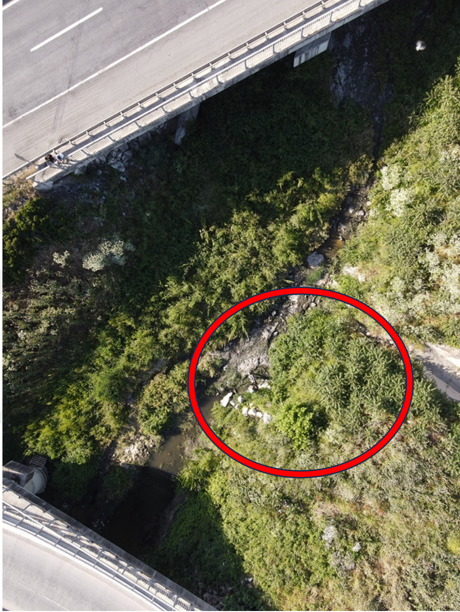
Şekil 5. Silivri’de, Kınalı Dere üzerinde bir köprüye ait olduğu düşünülen kalıntılar.
