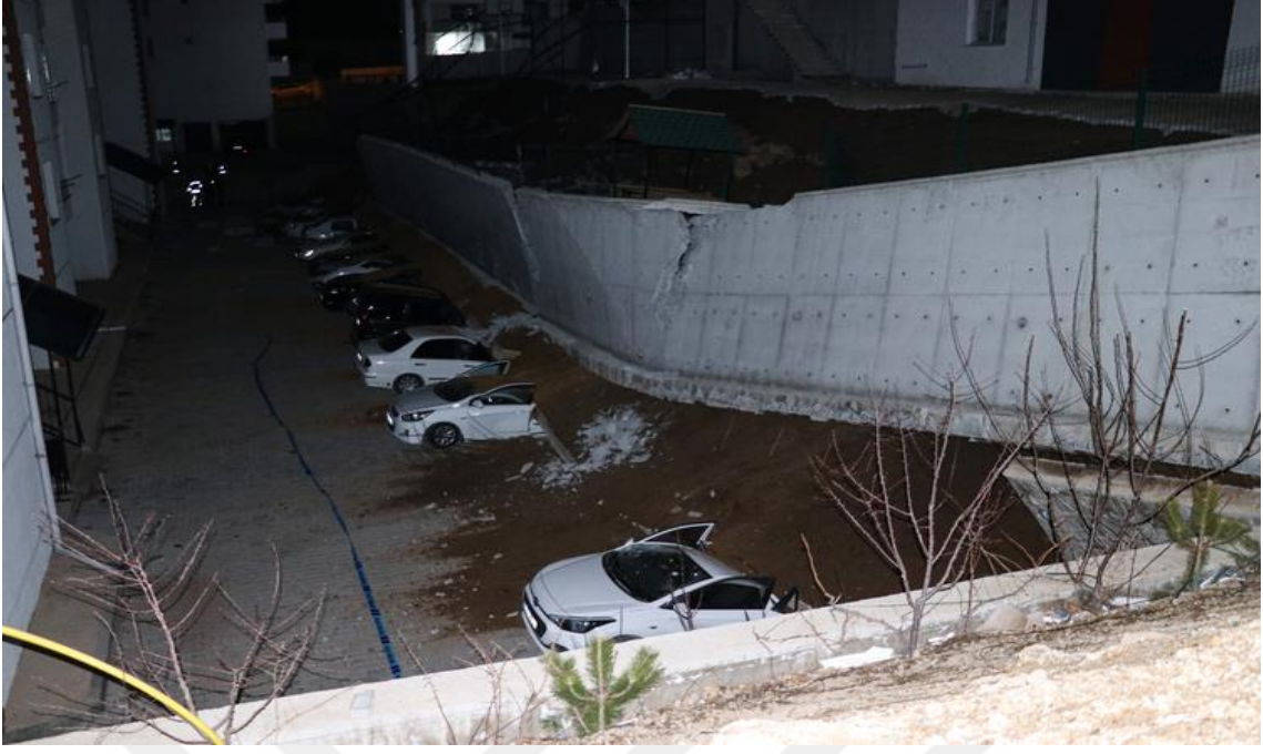
Resim 4.61. Heyelan afeti yapısal hasar alan yapıların görseli, Merkez, Yozgat
