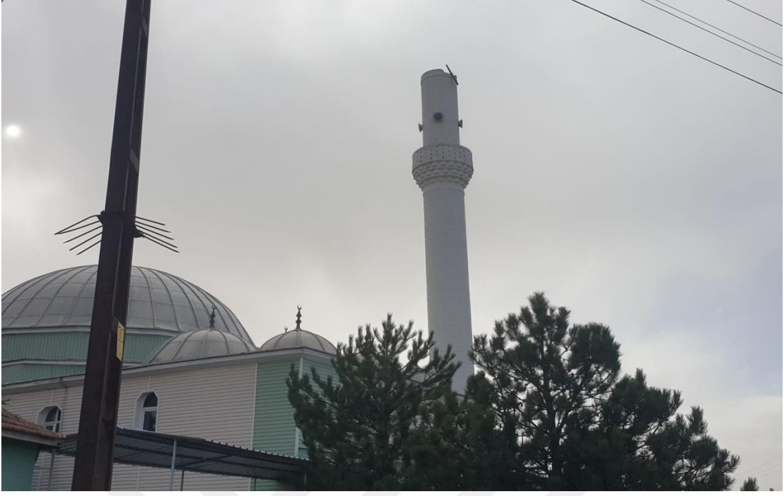
Resim 5.3. Minare şerefiyesi yapısal hasar alan yapıların görseli, 2023, Yerköy Yozgat
