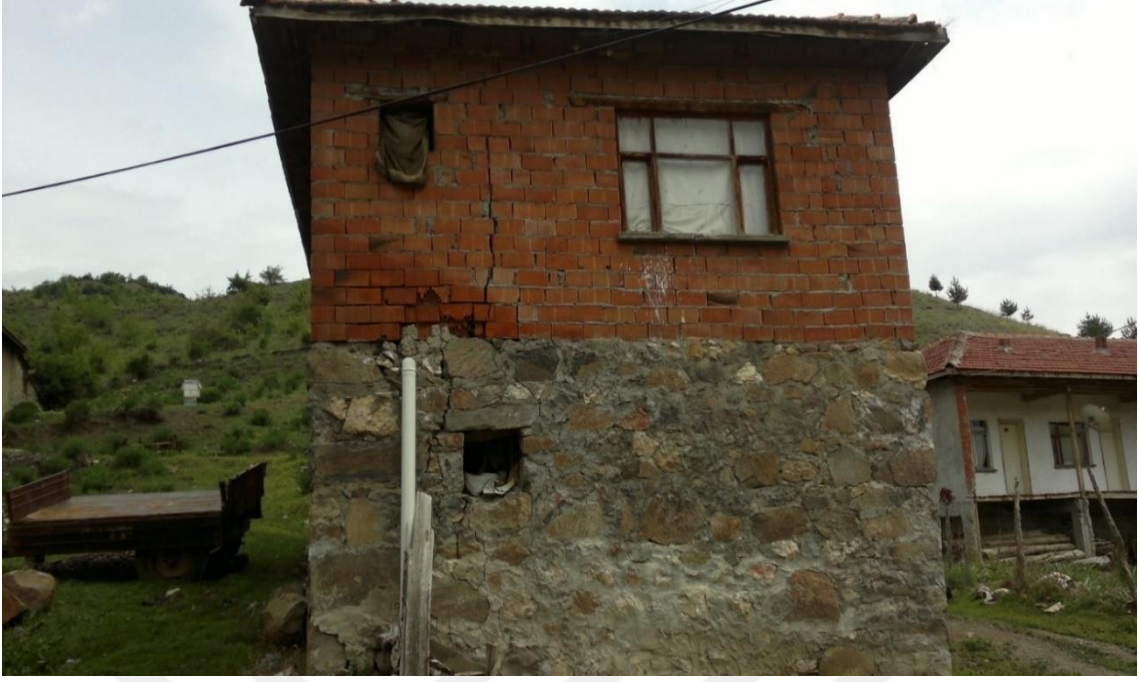
Resim 4.57. Heyelan afeti yapısal hasar alan yapıların görseli, 2014, Dereçiftlik, Kadişehri
