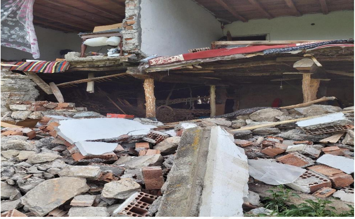
Resim 4.68. Sulusaray depremi nedeniyle hasar alan yapılar, 2024, Kadişehri, Yozgat
