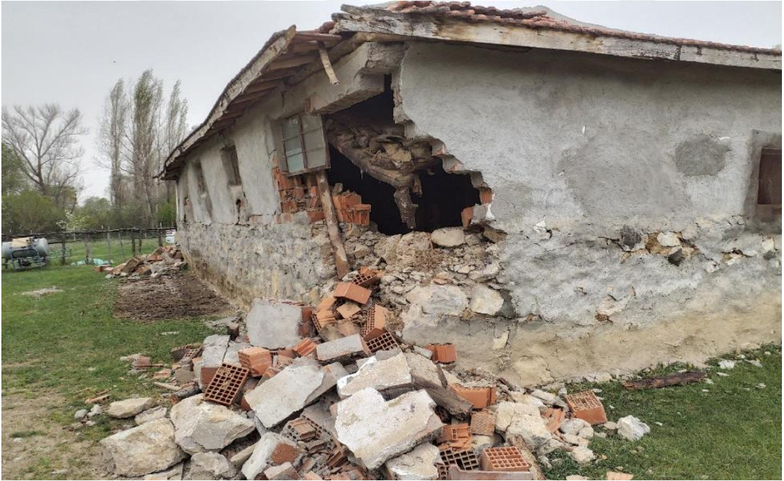
Resim 4.77. Sulusaray depremi nedeniyle hasar alan yapılar, 2024, Kadişehri, Yozgat
