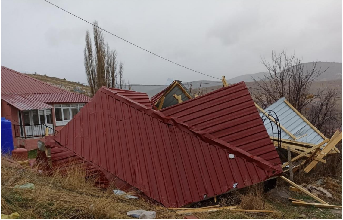
Resim 4.34. Fırtına Afeti hasar görseli, 2023, Akdağmadeni, Yozgat
