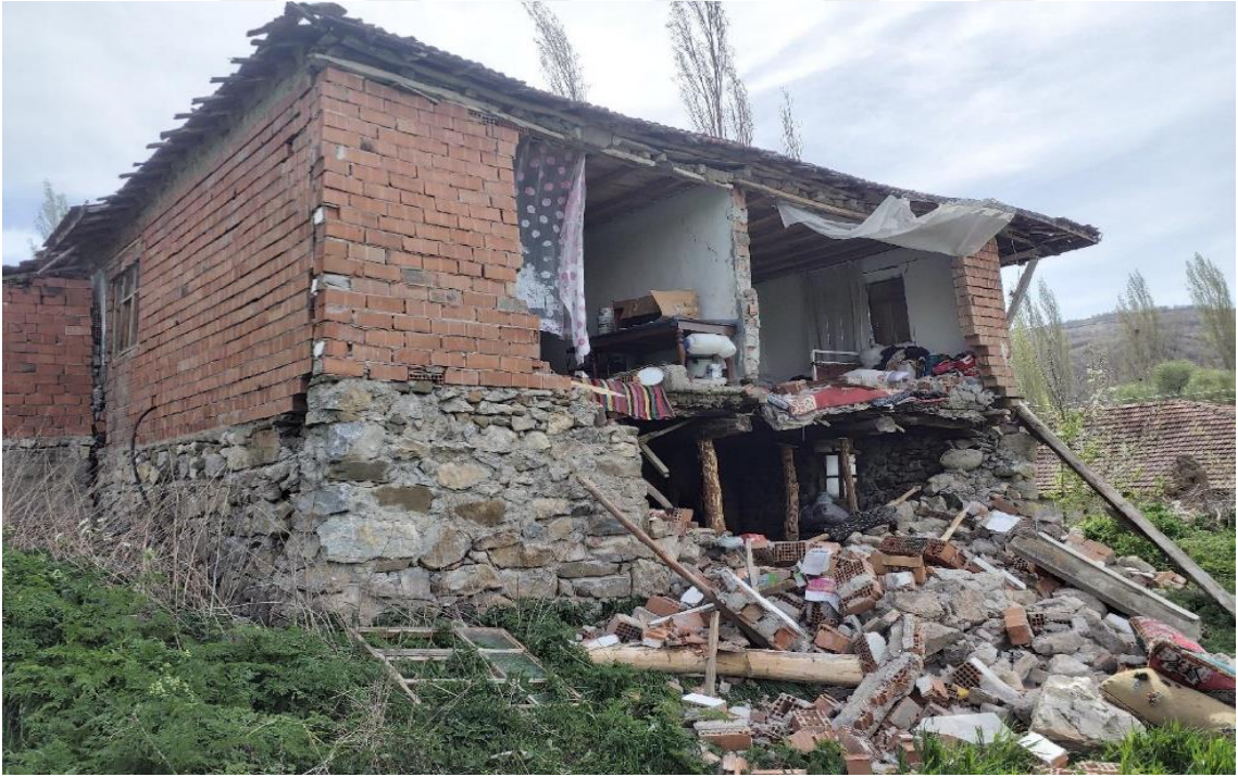
Resim 4.71. Sulusaray depremi nedeniyle hasar alan yapılar, 2024, Kadışehri, Yozgat
