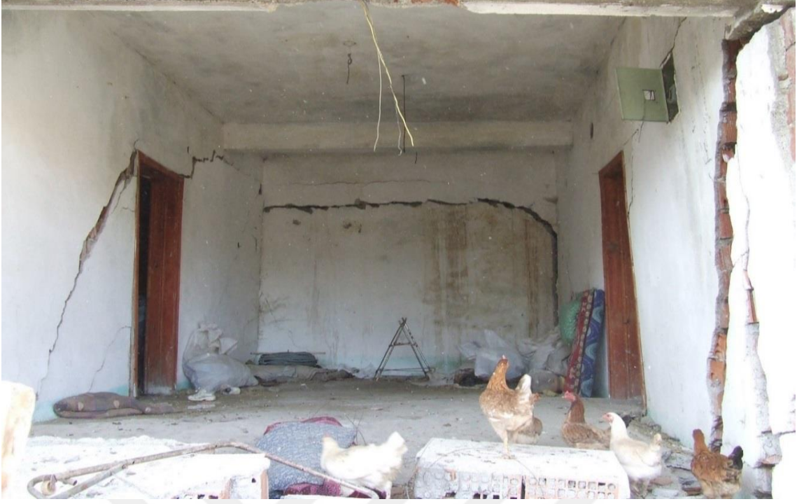
Resim 4.49. Heyelan afeti yapısal hasar alan yapıların görseli, 2013, Tarhana, Akdağmadeni
