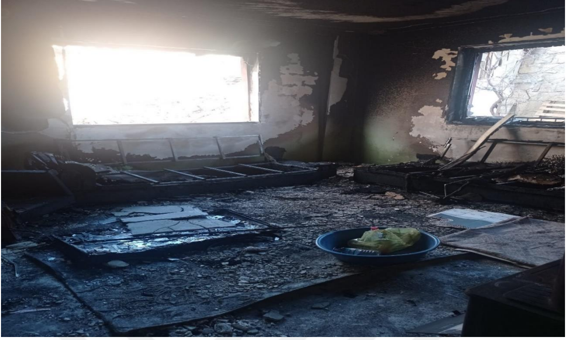
Resim 4.24. Yangın Afeti hasar görseli, 2022, Yerköy, Yozgat
