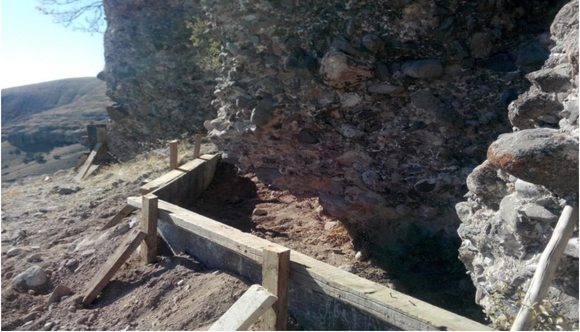
Resim 4.42. Kaya düşmesine bağlı yapısal önlem çalışmasına dair görsel, 2015, Beyvelioğlu köyü, Yozgat
