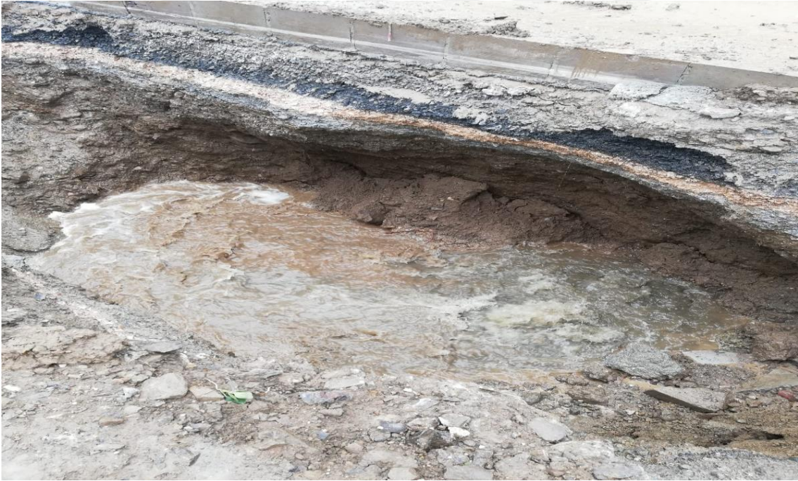
Resim 4.19. Yozgat merkez ilçesinde 2023'de meydana gelen sel/su baskını hasar görseli
