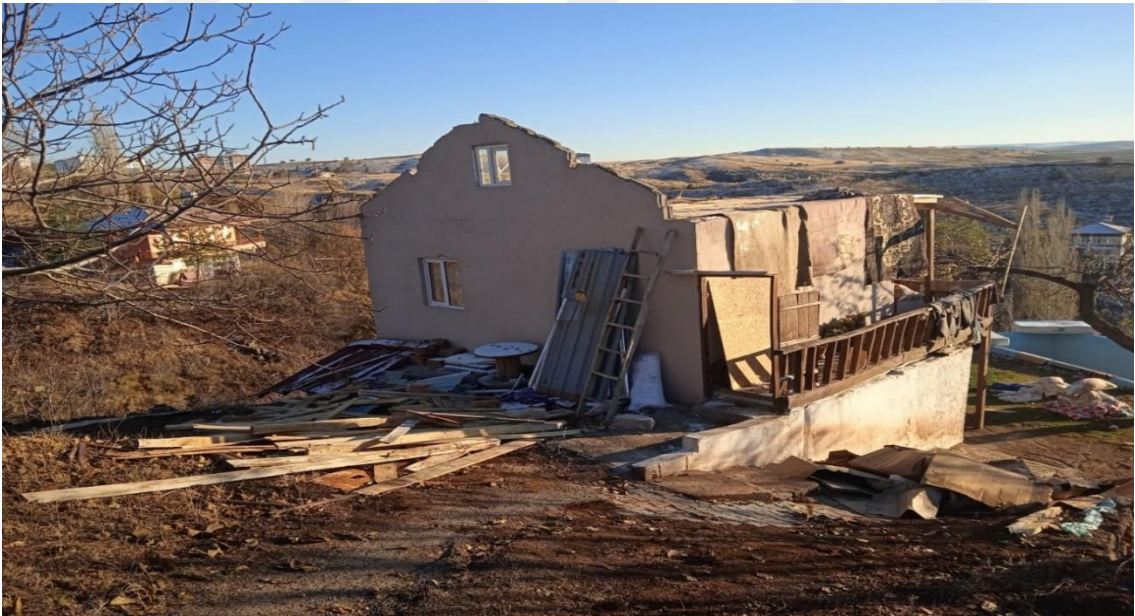
Resim 5.2. Çatı katı yapısal hasar alan yapıların görseli, 2023, Merkez, Yozgat
