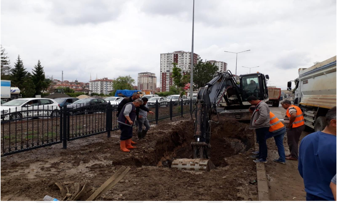
Resim 4.20. Yozgat merkez ilçesinde 2023’de meydana gelen sel/su baskını hasar görseli
