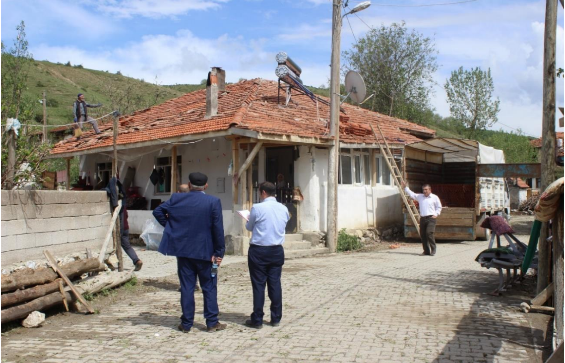
Resim 4.36. Dolu Afeti hasar görseli, Hanözü Köyü, 2018, Kadışehri, Yozgat
