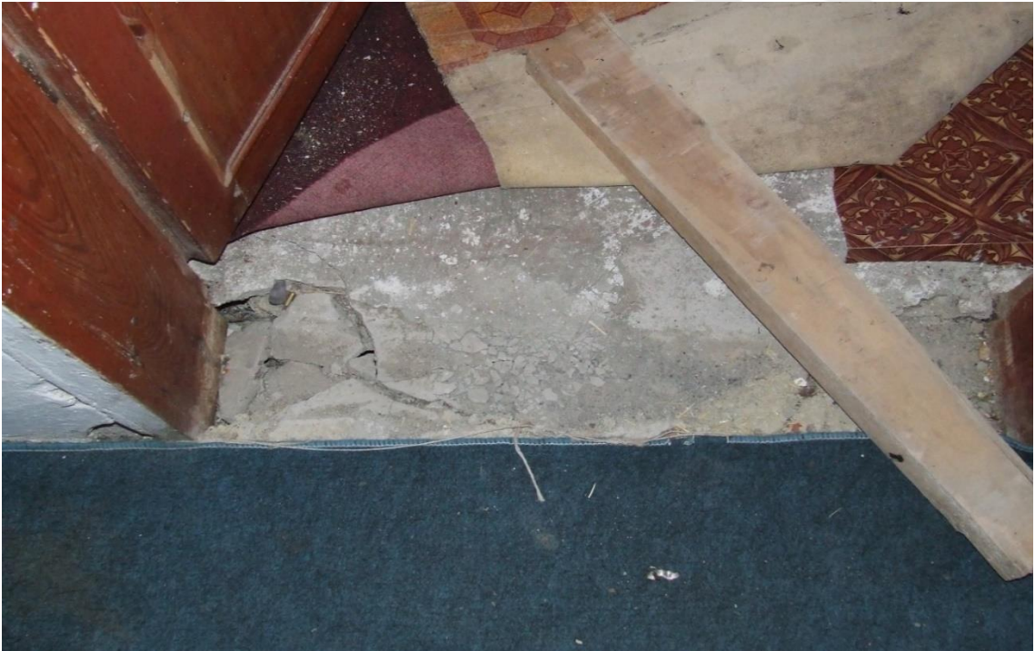
Resim 4.52. Heyelan afeti yapısal hasar alan yapıların görseli, 2013, Tarhana, Akdağmadeni
