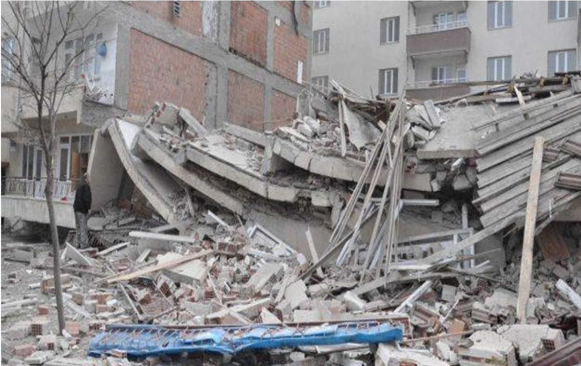
Resim 4.63. Deprem afeti yapısal hasar alan yapıların görseli, 2016, Yerköy, Yozgat
