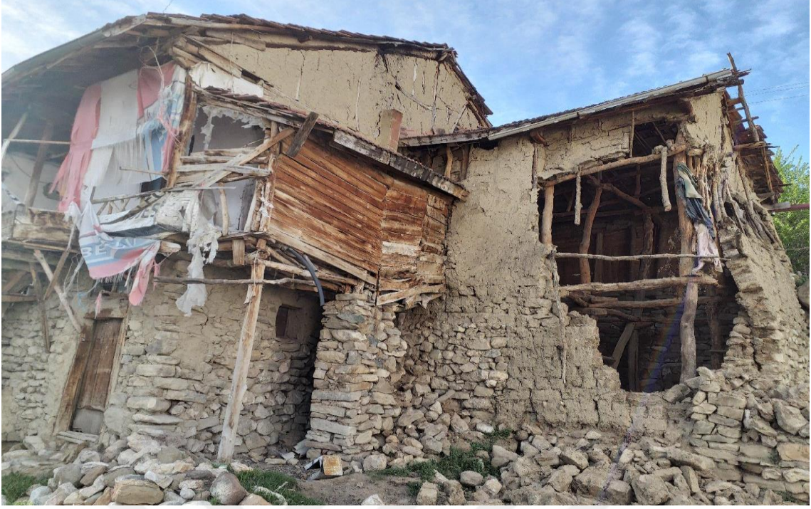
Resim 4.70. Sulusaray depremi nedeniyle hasar alan yapılar, 2024, Kadışehri, Yozgat
