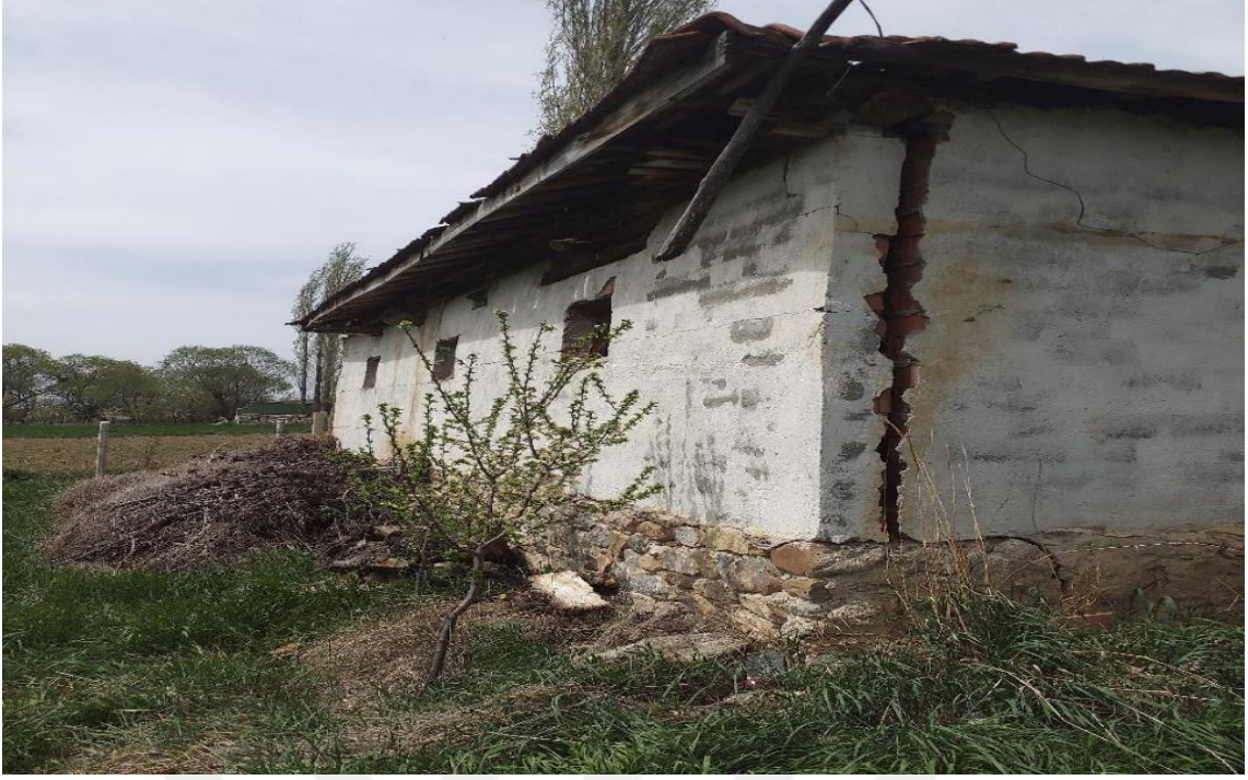
Resim 4.76. Sulusaray depremi nedeniyle hasar alan yapılar, 2024, Kadişehri, Yozgat
