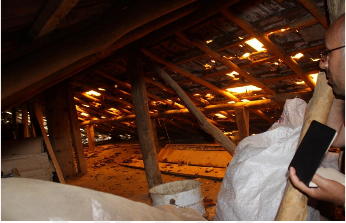
Resim 4.35. Dolu Afeti hasar görseli, Hanözü Köyü, 2018, Kadışehri, Yozgat
