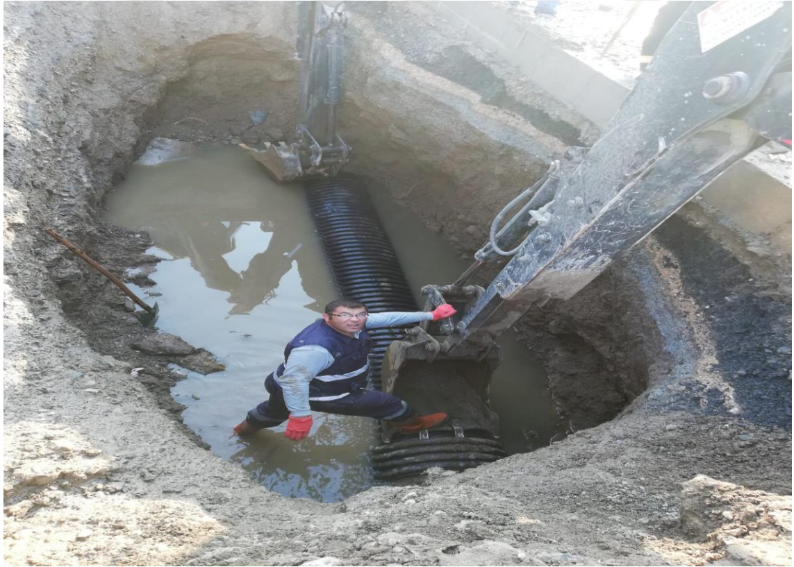
Resim 4.21. Yozgat merkez ilçesinde 2023’de meydana gelen sel/su baskını hasar görseli
