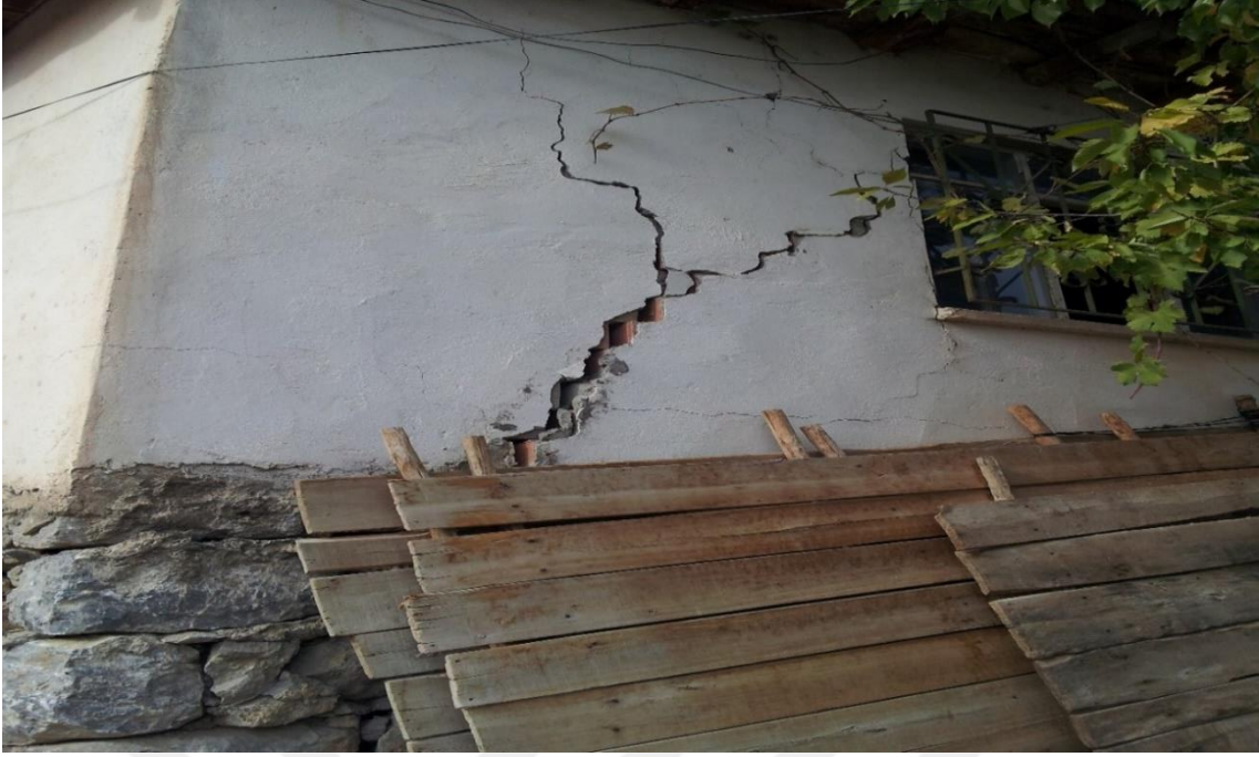
Resim 4.55. Heyelan afeti yapısal hasar alan yapıların görseli, 2014, Dereçiftlik, Kadişehri
