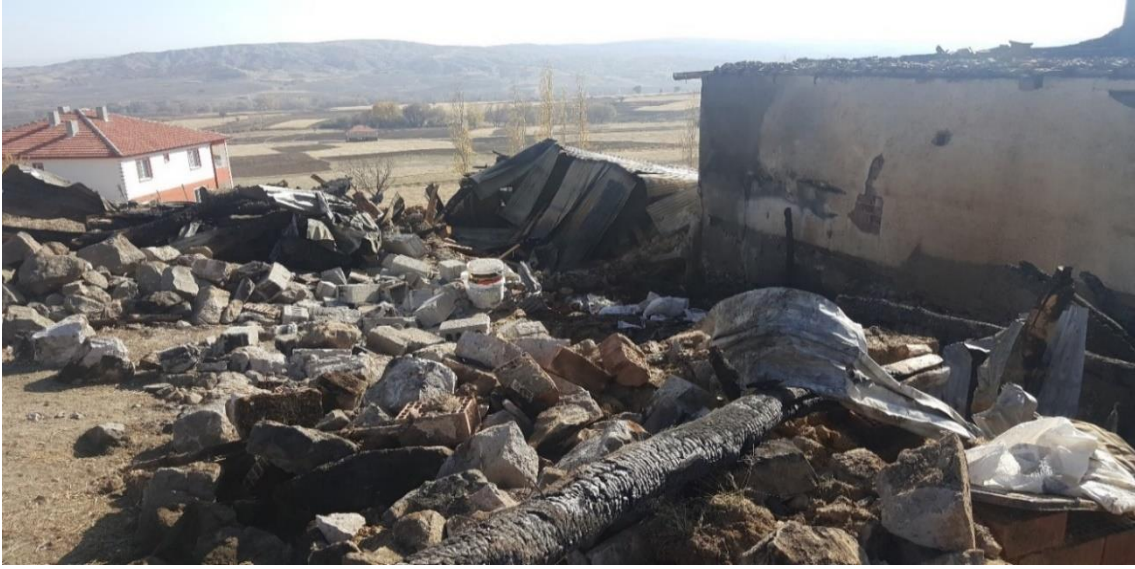
Resim 4.22. Yangın Afeti hasar görseli, 2022, Akdağmadeni, Yozgat
