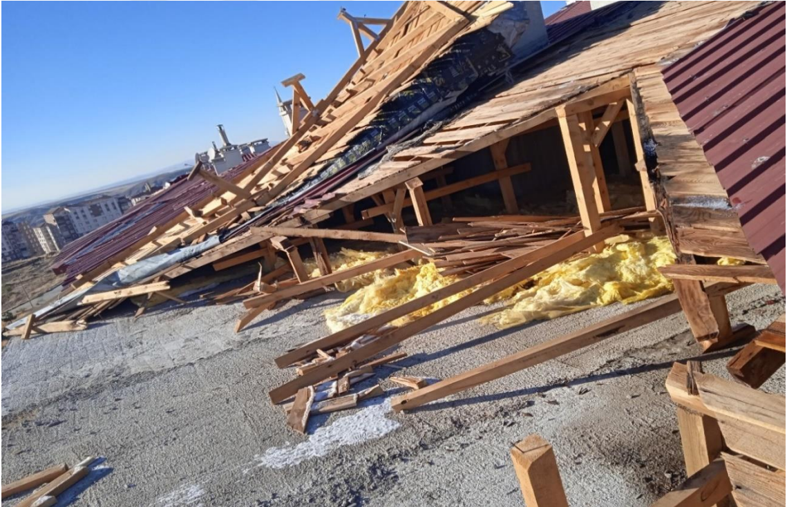
Resim 4.32. Fırtına Afeti hasar görseli, 2023, Merkez, Yozgat
