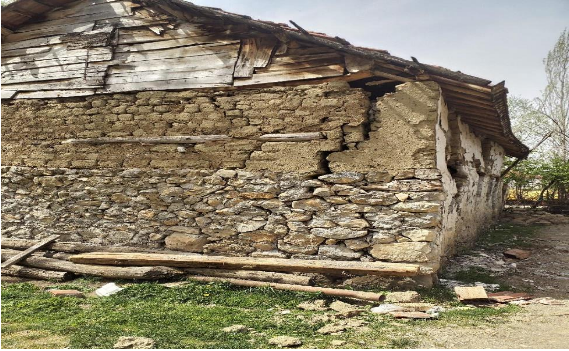
Resim 4.73. Sulusaray depremi nedeniyle hasar alan yapılar, 2024, Kadışehri, Yozgat
