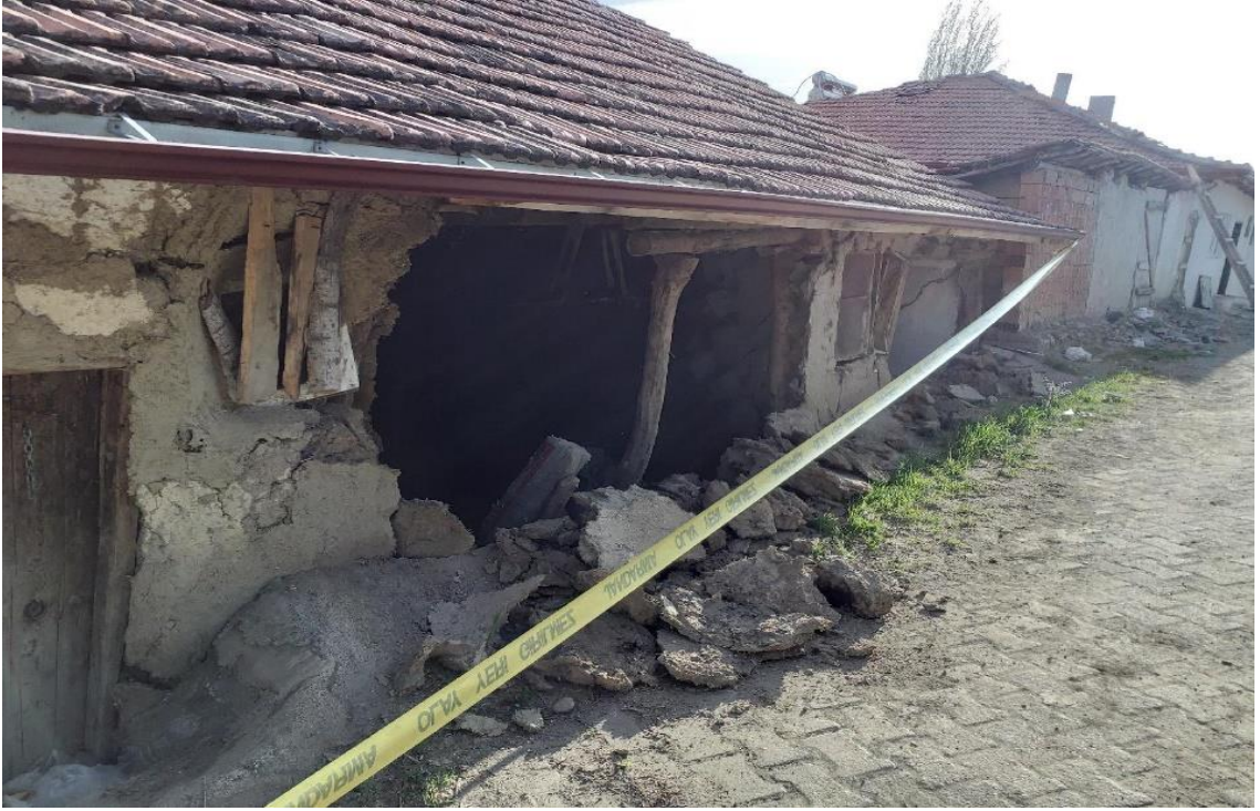
Resim 4.69. Sulusaray depremi nedeniyle hasar alan yapılar, 2024, Kadişehri, Yozgat
