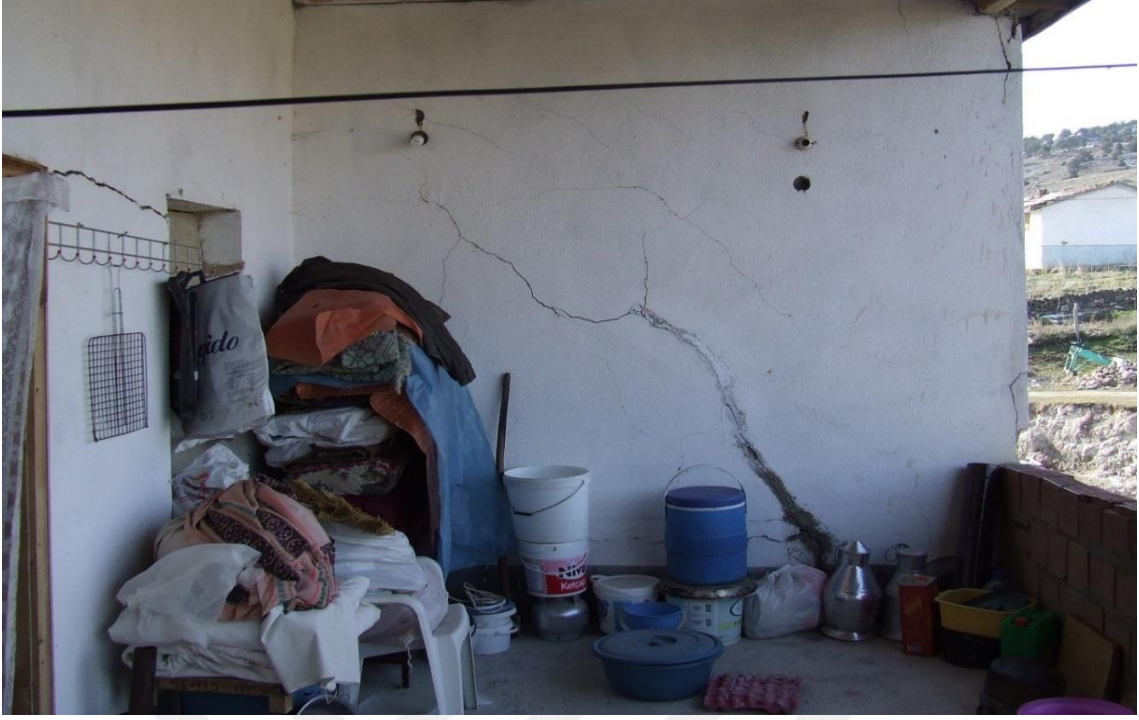
Resim 4.51. Heyelan afeti yapısal hasar alan yapıların görseli, 2013, Tarhana, Akdağmadeni
