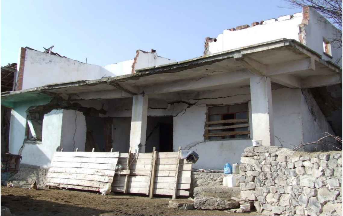
Resim 4.48. Heyelan afeti yapısal hasar alan yapıların görseli, 2013, Tarhana, Akdağmadeni
