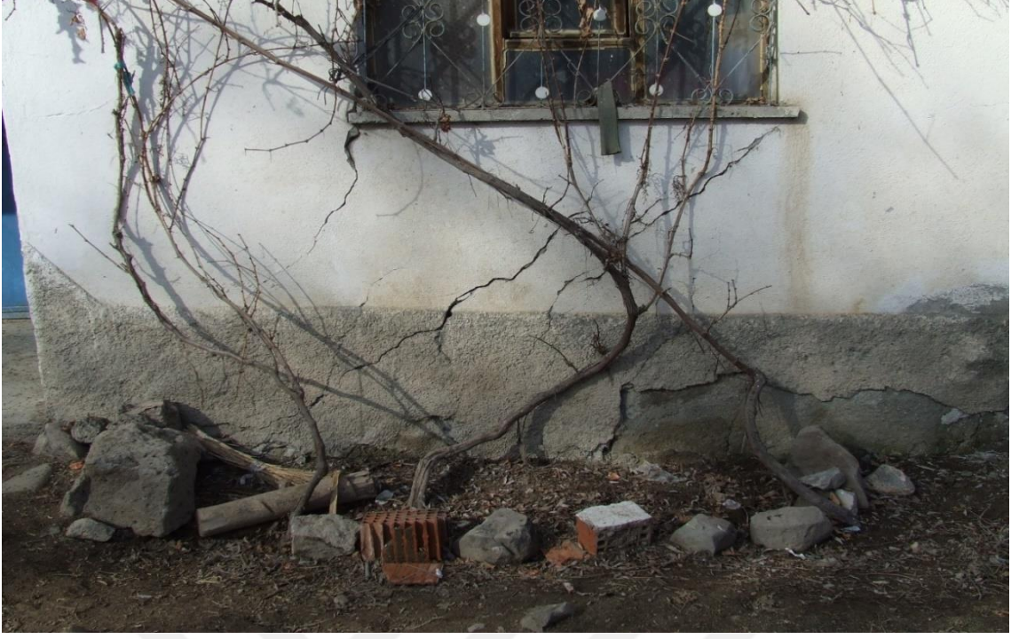
Resim 4.47. Heyelan afeti yapısal hasar alan yapıların görseli, 2013, Tarhana, Akdağmadeni
