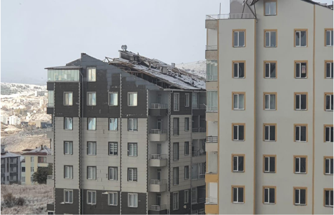
Resim 4.30. Fırtına Afeti hasar görseli, 2023, Merkez, Yozgat
