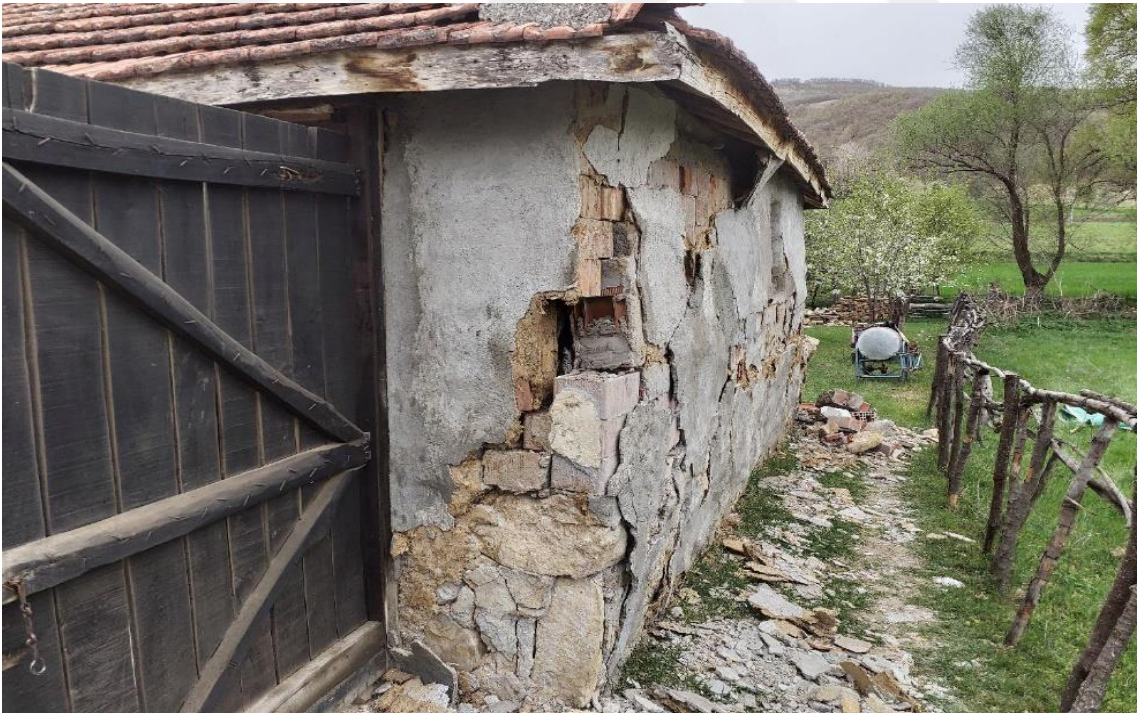
Resim 4.75. Sulusaray depremi nedeniyle hasar alan yapılar, 2024, Kadışehri, Yozgat
