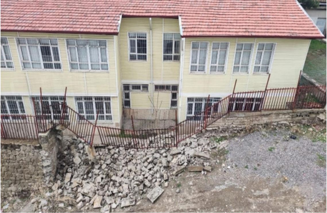
Resim 4.62. Heyelan afeti yapısal hasar alan yapıların görseli, Merkez, Yozgat
