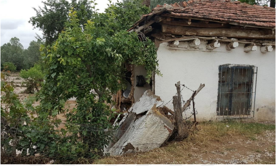
Resim 4.12. Yozgat Gökçekışla Köyünde 2019'da meydana gelen sel/su baskını hasar görseli
