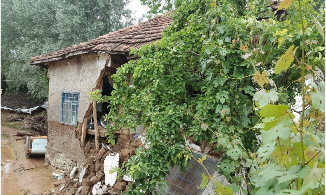
Resim 4.11. Yozgat Gökçekışla Köyünde 2019'da meydana gelen sel/su baskını hasar görseli
