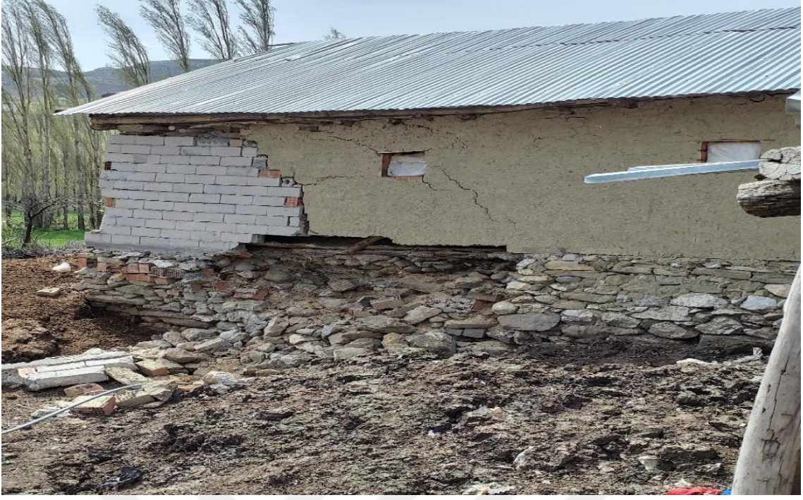
Resim 4.72. Sulusaray depremi nedeniyle hasar alan yapılar, 2024, Kadışehri, Yozgat
