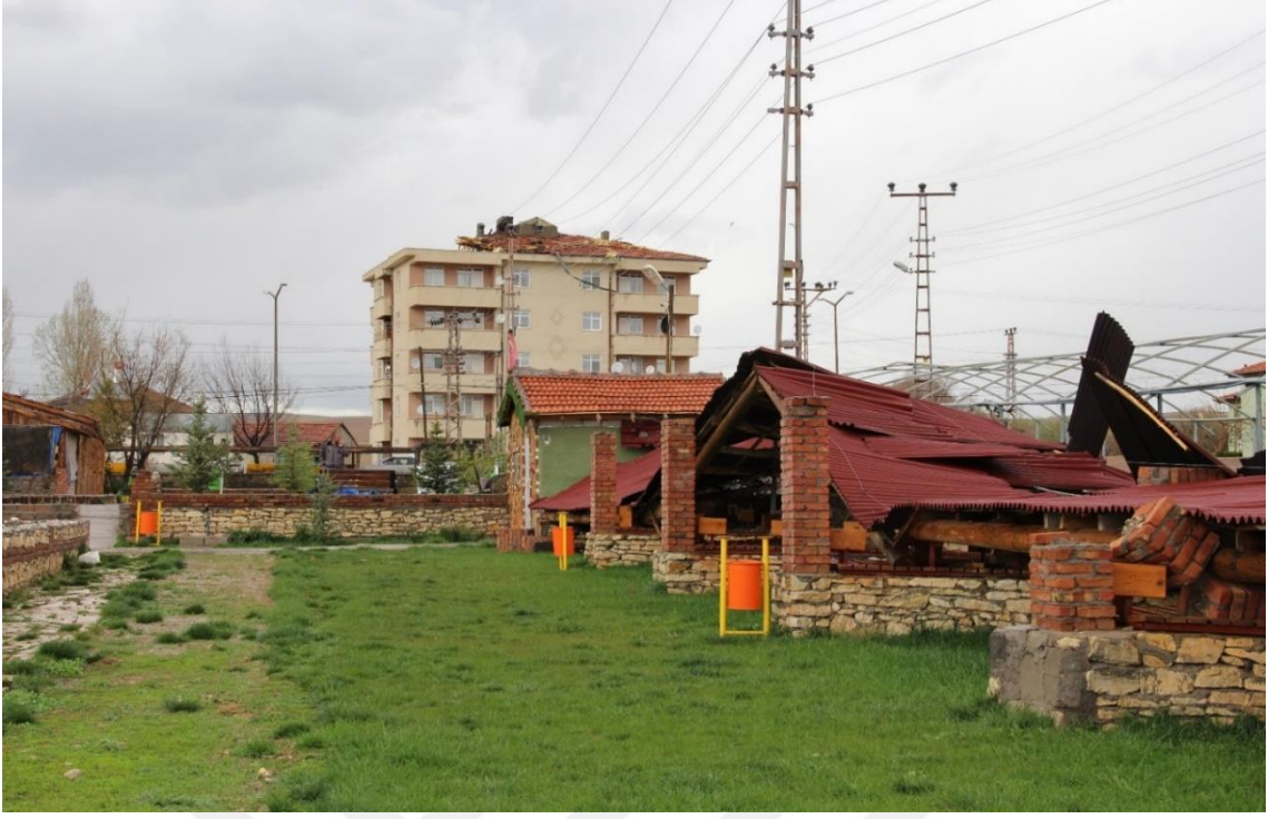
Resim 4.29. Fırtına Afeti hasar görseli, 2018, Çandır, Yozgat
