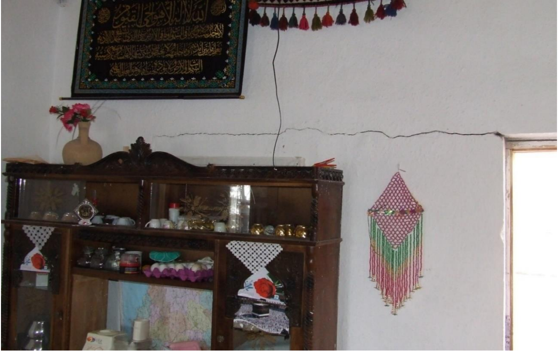
Resim 4.50. Heyelan afeti yapısal hasar alan yapıların görseli, 2013, Tarhana, Akdağmadeni
