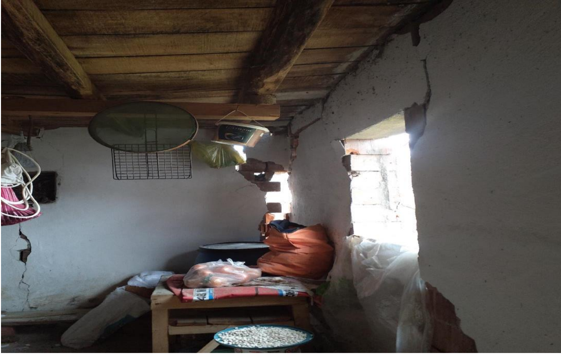
Resim 4.79. Sulusaray depremi nedeniyle hasar alan yapılar, 2024, Kadışehri, Yozgat
