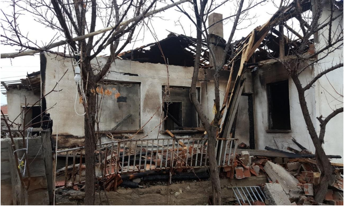
Resim 4.25. Yangın afetine bağlı yapısal hasar görseli, 2022, Yerköy, Yozgat
