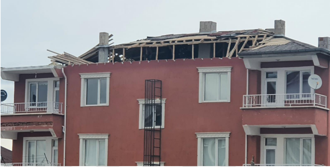
Resim 5.1. Çatı katı yapısal hasar alan yapıların görseli, 2023, Merkez, Yozgat
