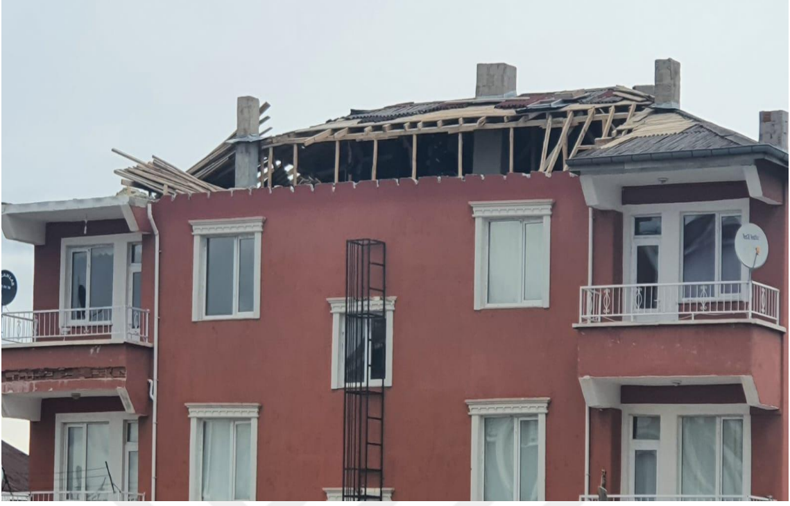
Resim 4.31. Fırtına Afeti hasar görseli, 2023, Merkez, Yozgat
