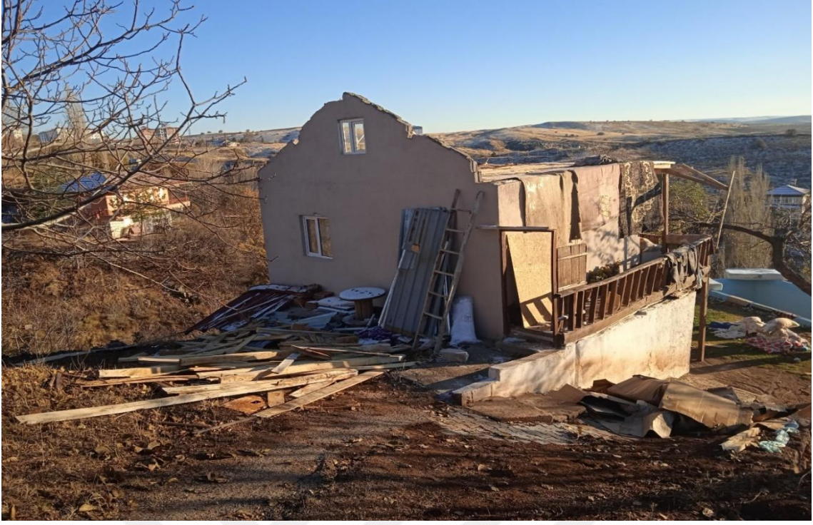
Resim 4.33. Fırtına Afeti hasar görseli, 2023, Merkez, Yozgat
