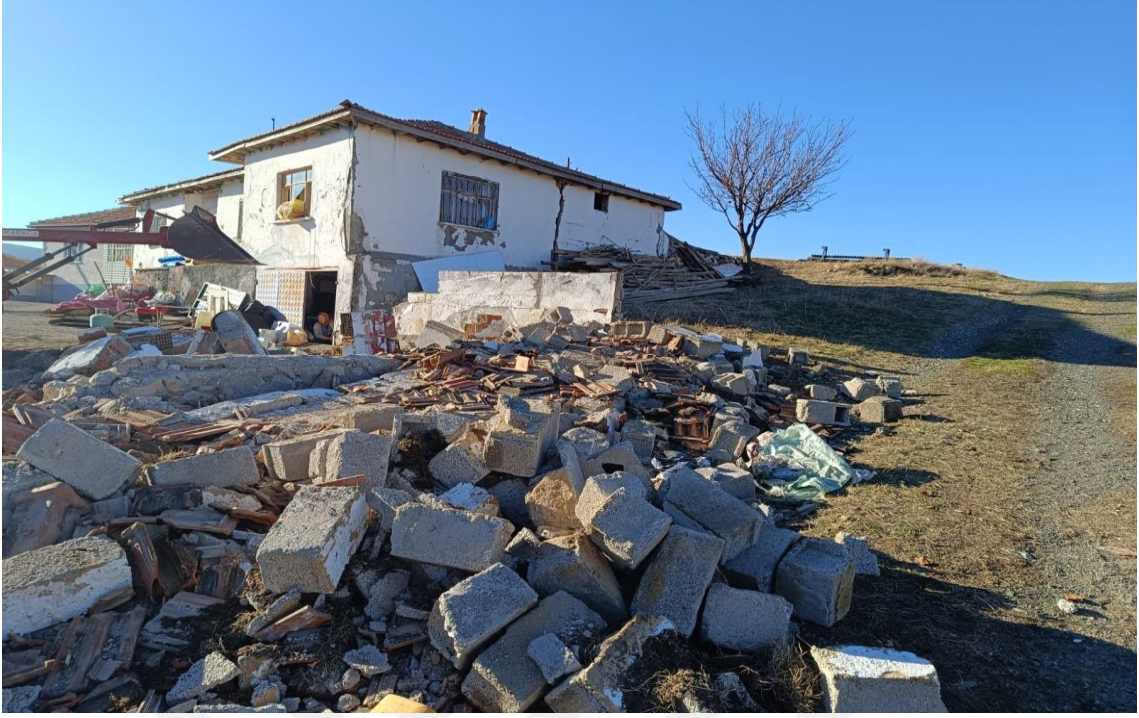
Resim 5.5. Duvar yapısal hasar alanı görseli, 2023, Aydıncık, Yozgat
