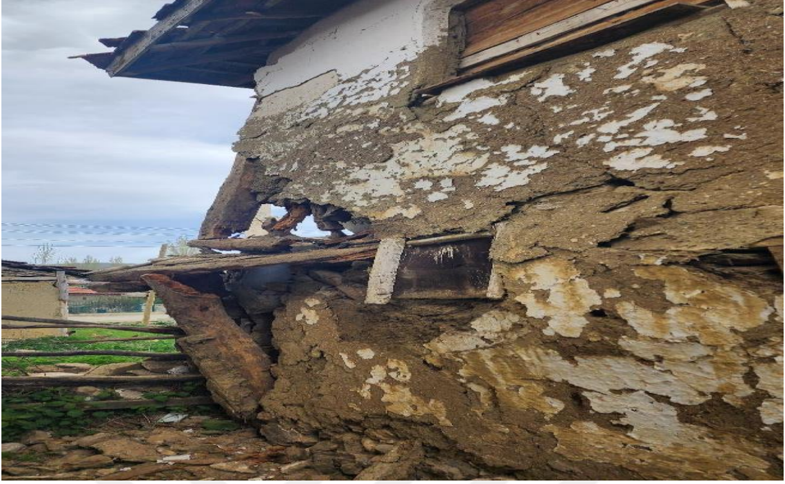
Resim 4.74. Sulusaray depremi nedeniyle hasar alan yapılar, 2024, Kadışehri, Yozgat
