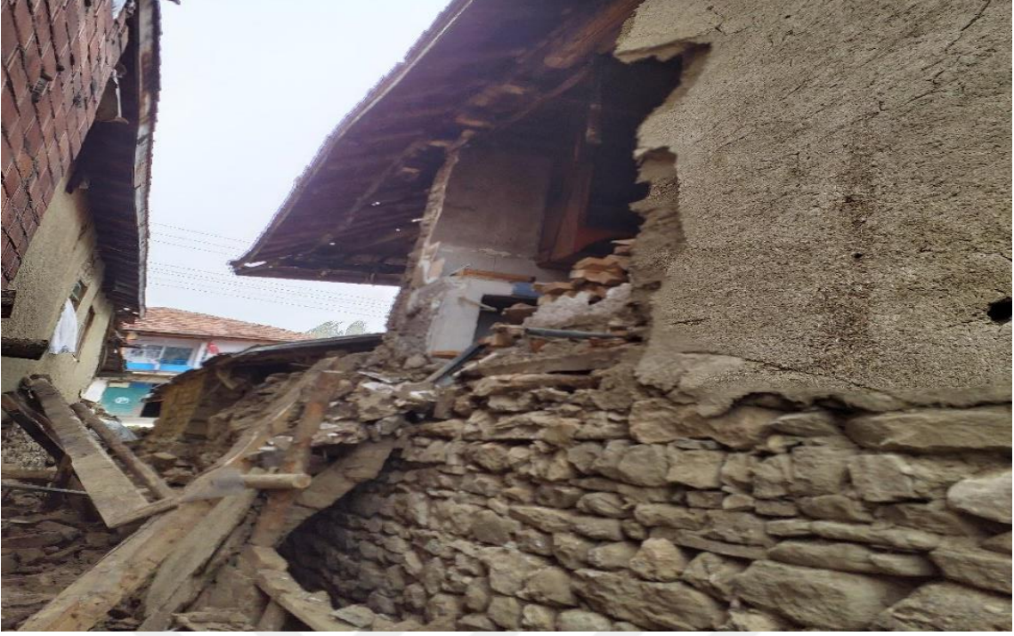
Resim 4.78. Sulusaray depremi nedeniyle hasar alan yapılar, 2024, Kadışehri, Yozgat
