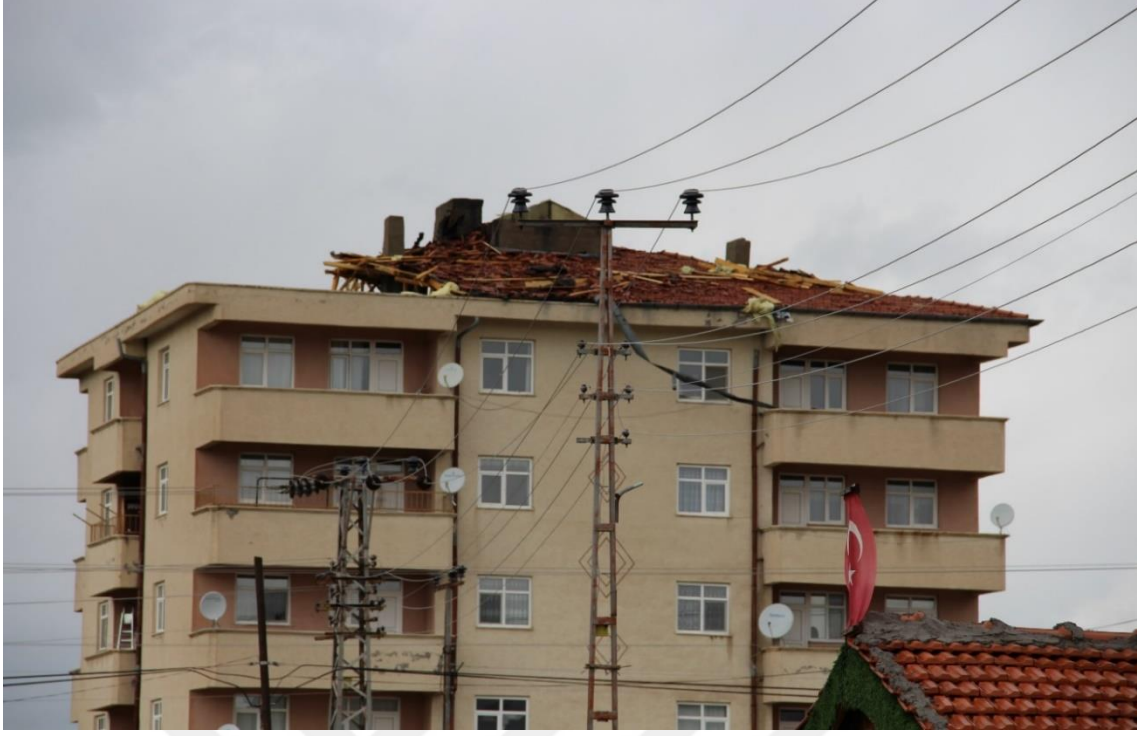
Resim 4.27. Fırtına Afeti hasar görseli, 2018, Çandır, Yozgat
