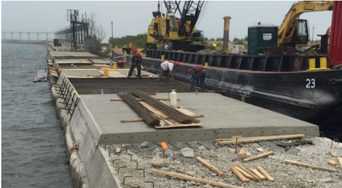
Şekil 3.6 : Rıhtım inşaatında yetersiz güvenlik önlemleri (Url-28).
