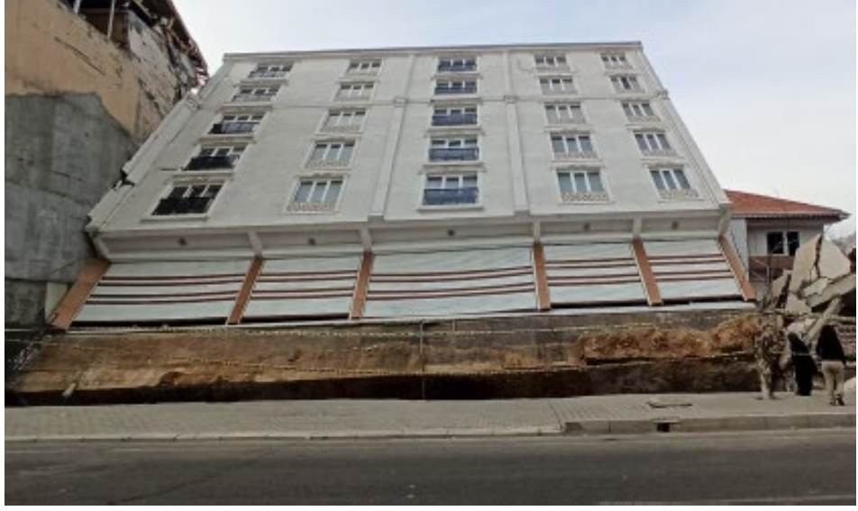
Şekil 3.7: Sıvılaşma sonucu taşıma gücünü kaybeden zeminin üzerinde bulunan binanın geriye doğru devrilmesi, (Gölbaşı, Adıyaman) (Üstün vd., 2023)
