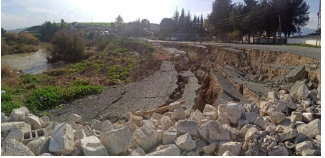
Şekil 3.11: Asi Nehri'nde gelişen yanal yayılma nedeniyle hasar gören yol (Alaattin mahallesi, Antakya) (Üstün vd., 2023)
