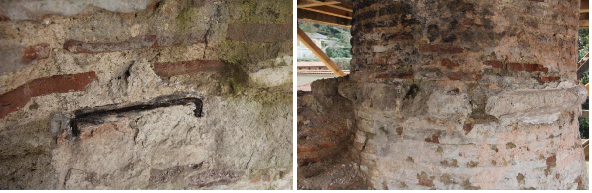
Şekil 3.5: Gövde altındaki silme taş bilezikteki hasarlar
