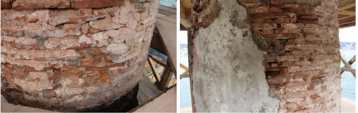
Şekil 3.7: Gövdesindeki tuğla duvar hasarları
