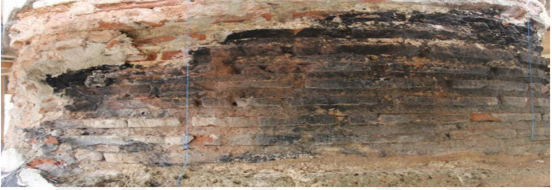
Şekil 3.6: Gövde altındaki yangın hasarları
