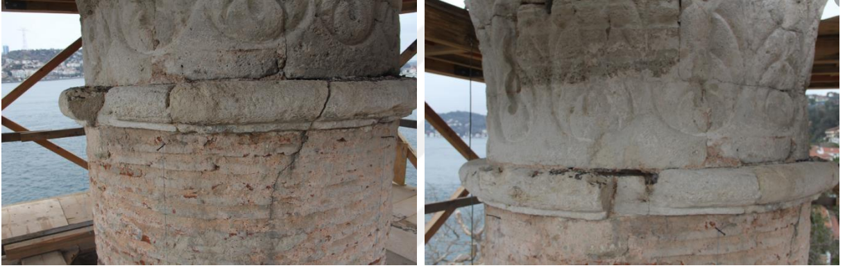
Şekil 3.9: Şerefe altı taşlardaki hasarlar
