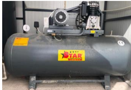
Şekil 3.3. Hava kompresörü ve tankı
