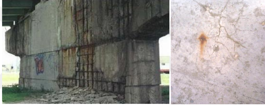
Şekil 2.11. (a) Korozyona uğramış köprü ayağı, (b) Korozyonun betonun dışına çıkmaya başlaması [25]
