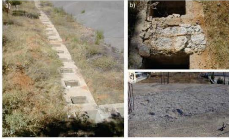
Şekil 2.5. a) ve b) Donma çözünme hasarına uğramış temel, c) Betonarme bir döşemede oluşan taze beton hasarı [3]
