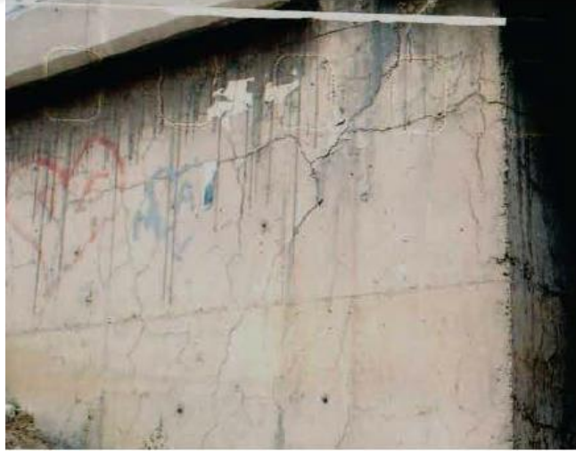
Şekil 2.15. ASR hasarına uğramış köprü ayağı [3]
