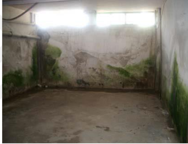
Şekil 2.2. Yeraltı suyunun bodrum duvar ve döşemelerinde neden olduğu hasarlar [17]
