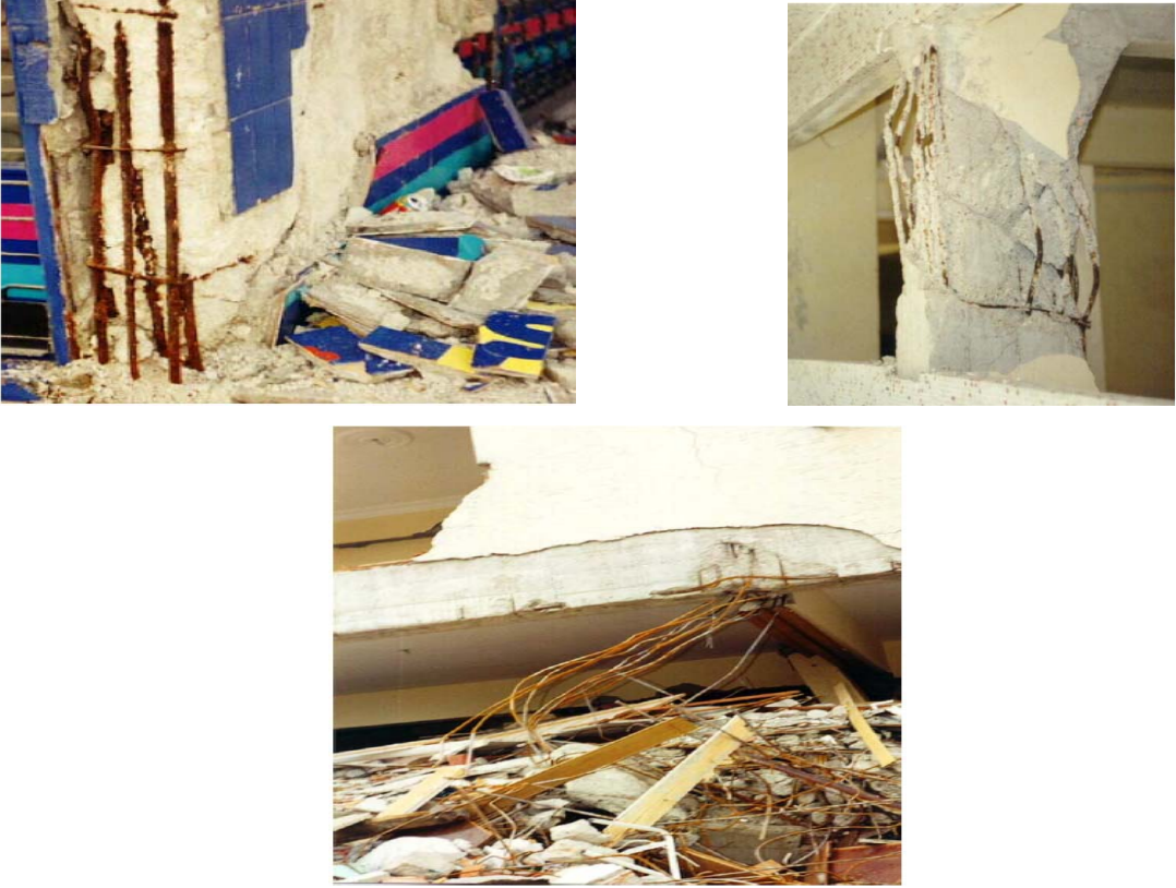
Şekil 3.1 Betonarme Yapılar Üzerinde Deprem Etkisi Avcılar 1999
