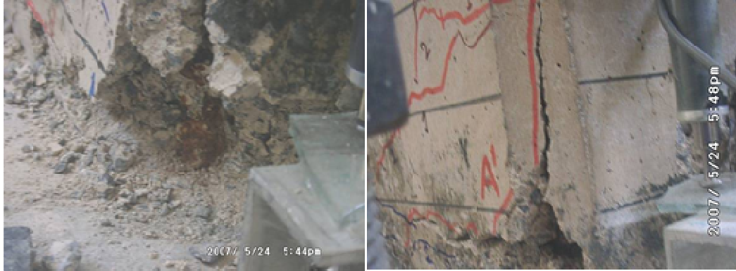
Şekil 4.19 : Beton Örtüsünde Dökülme ve Ortaya Çıkan Donatı
