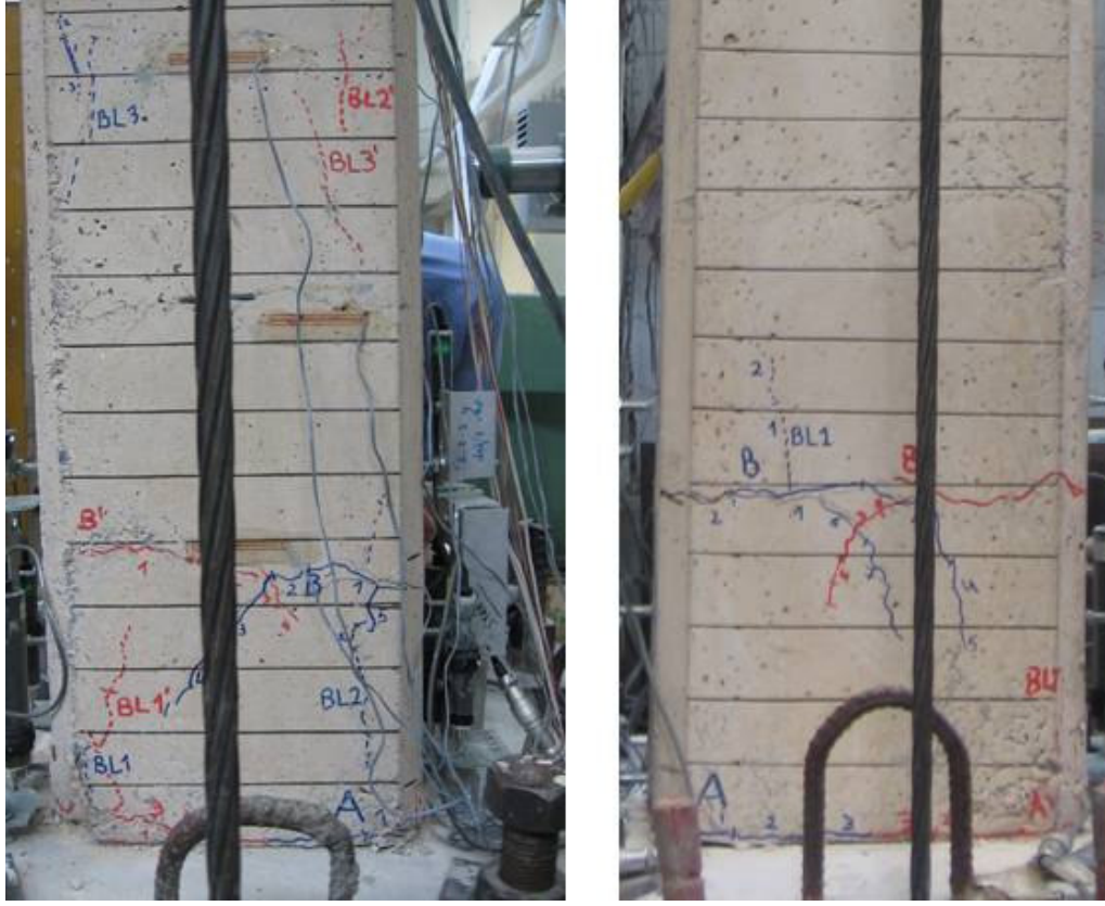
Şekil Ek A. 9 : Çatlak Bölgesi (Ö.O. : % 3.50)
