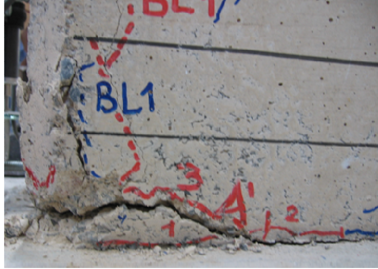
Şekil 4.4 : %3.50 Öteleme Oranında Birleşim Bölgesinde Betonda Kopma
