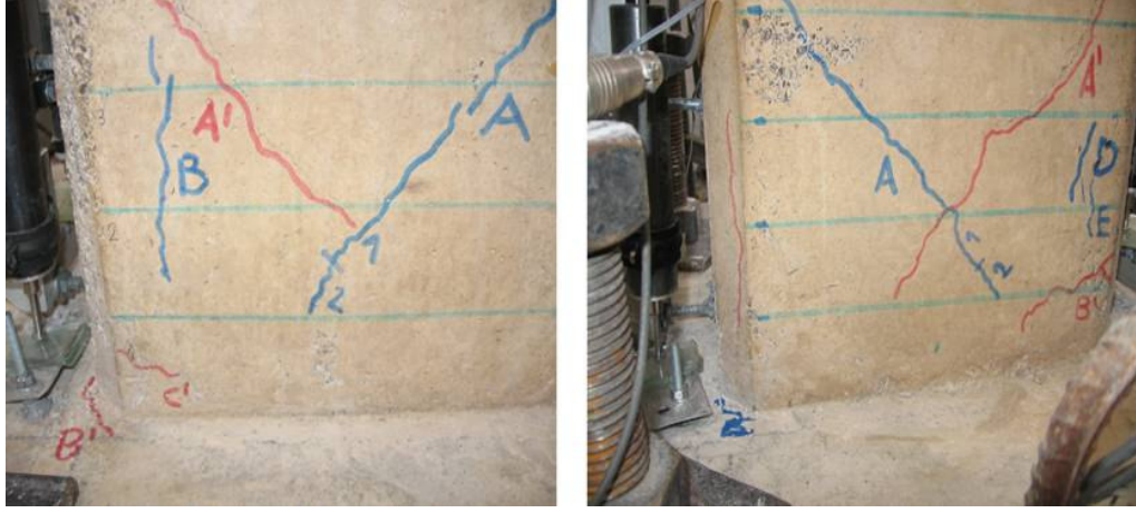
Şekil Ek A. 23 : Çatlak Bölgesi (Ö.O. : % 1.00)
