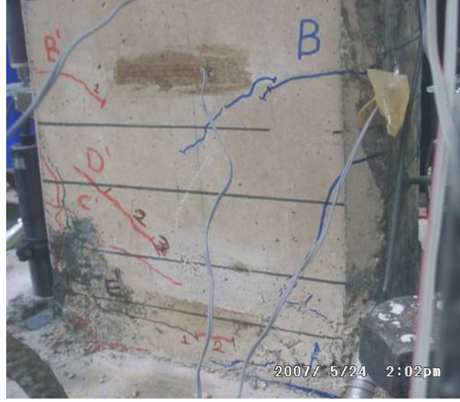
Şekil 4.18 : Beton Örtüsünde Dökülme Başlangıcı
