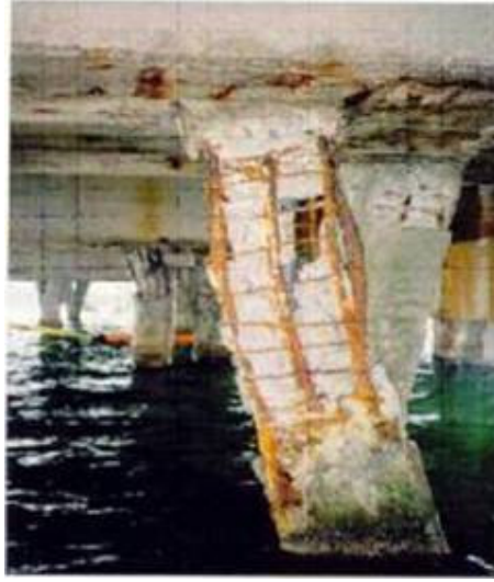
Şekil 2.1 : Aderans Kaybı Sonucu Oluşmuş Hasar
