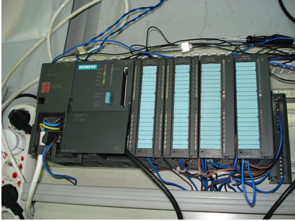
Şekil 4.2 : Sistemin Kontrolünde Kullanılan SIEMENS S7-300 PLC Cihazı.
