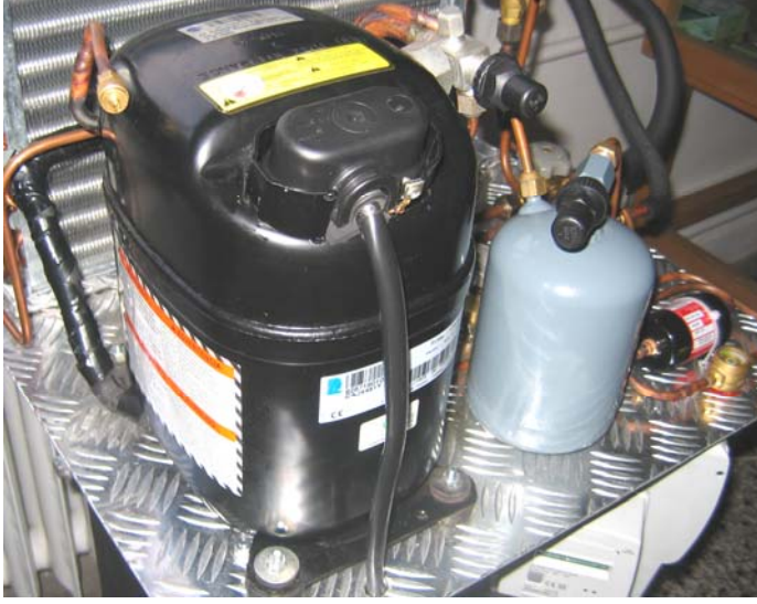
Şekil 4.4 Kompresör, Sıvı deposu, Filtre kurutucu ve Gözetleme camı
