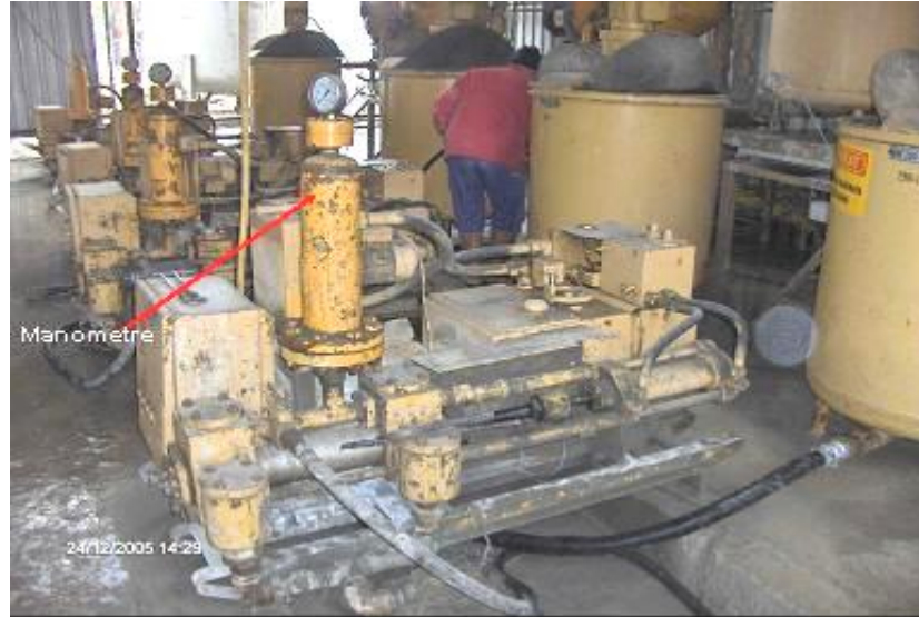
Şekil 3.19. Basıncın kontrolünü sağlayan manometre
