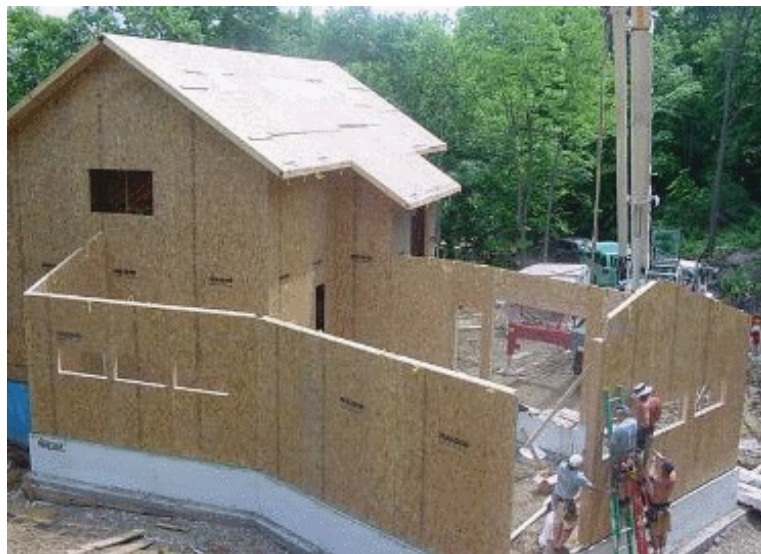
Resim 4.33. Sandviç panellerin yapıda kullanımı (151)
