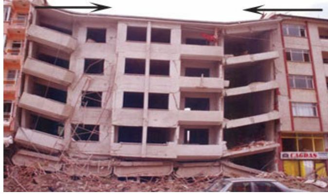
Şekil 2.6. 17 Ağustos Sakarya Depreminde Bitişik Nizam Düzeninde Yapılmış Binalar (İstanbul Büyükşehir Belediyesi Devlet Arşivi, 1999)
