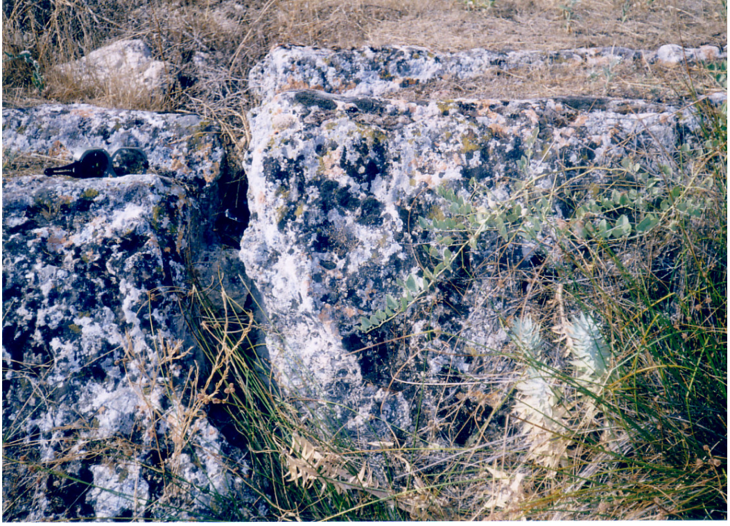
Şekil 3. Kendiliğinden oluşan kanal-tipi traverten.
