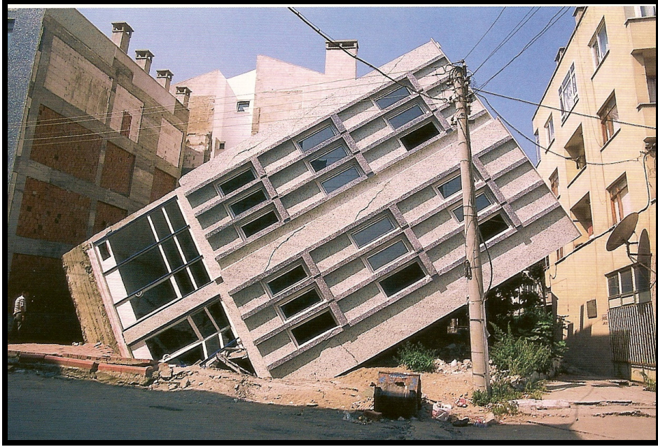
Şekil 4.5 Körfez Depremi: 17.08.1999: Tıgçılar Mahallesi'nde elverişsiz zemin ve yüksek taban suyu seviyesi nedeniyle yana yatan bir bina (Anon., 2000a).
