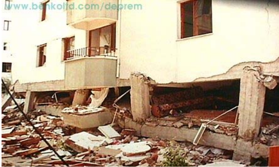
Şekil 2.21. Zemin katından depremde aldığı hasar sonucu yıkılmış apartman
