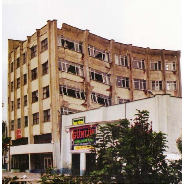
Şekil 2.5. Hasar gören vergi dairesi binası (Çiftçi, 1999)
