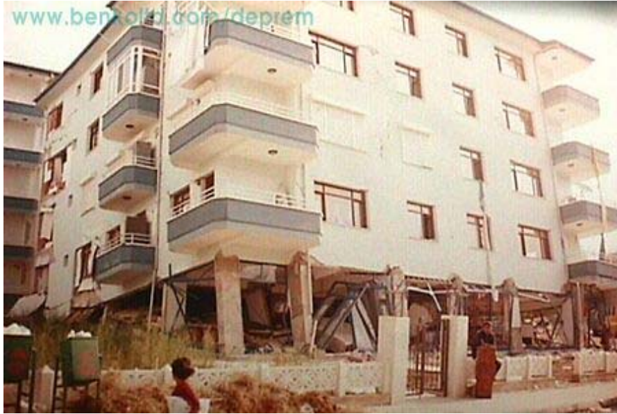
Şekil 2.23. Zemin katın yeterli strüktür desteğinin yapılmaması durumunda oluşan yapıdaki hasar ( http://www.benkold.com/deprem/hareket_ani.htm )
