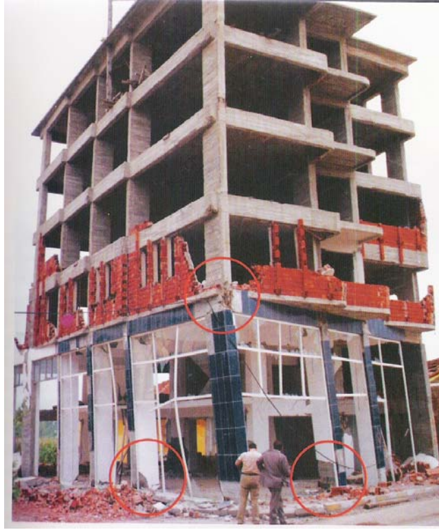
Şekil 2.3. Zemin katı dükkan olarak tasarlanmış, depremde hasar gören bina (Çiftçi, 1999)
