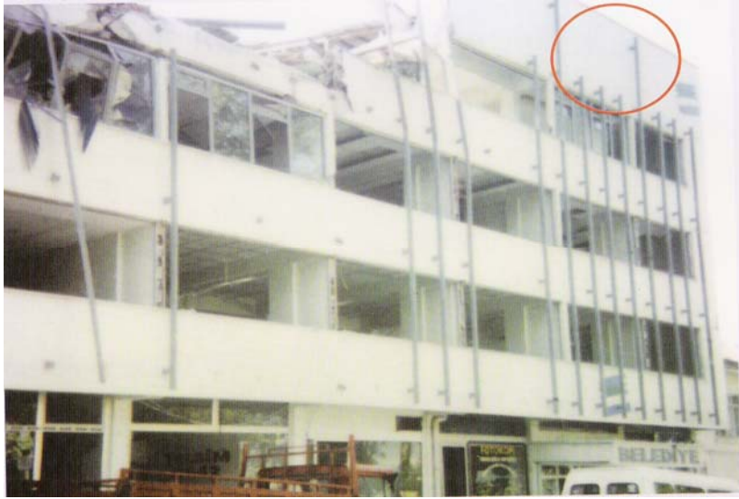
Şekil 2.14. Hasar görmüş kamu binası (Çiftçi, 1999)
