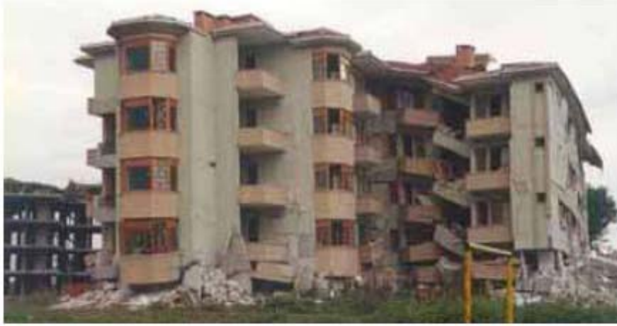
Şekil 2.24. Planda çok sayıda köşe ve girinti- çıkıntı oluşması sonucu Marmara depreminde hasar görmüş yapı (Balyemez ve Berköz, 2005)
