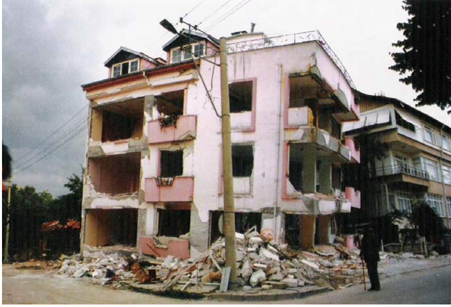
Şekil 2.12. Kolon yönleri tek istikamette konulmuş yapıda hasar (Çiftçi, 1999)
