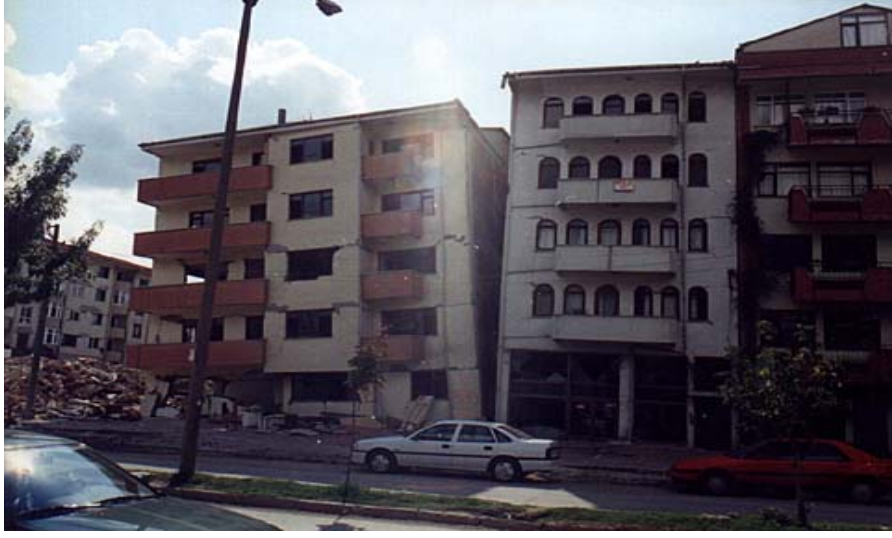
Şekil 2.19. Görülen iki binanın zemin sıvılaşması sonucu birbirinden ayrılması ( http://www.turkforum.net/ )
