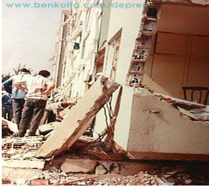
Şekil 2.22. Marmara depreminde zemin katı tamamen göçmüş konut binası
