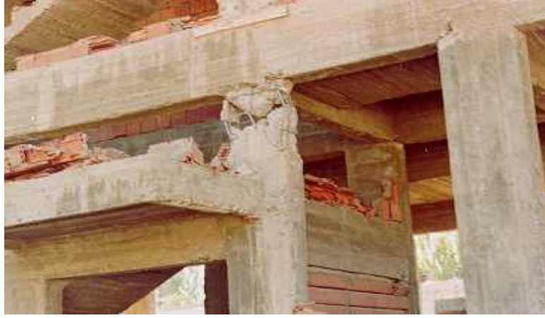
Şekil 2.18. Yapıda kısa kolon oluşumundan dolayı taşıyıcı elemanda görülen hasarlar (Darılmaz, 1999)
