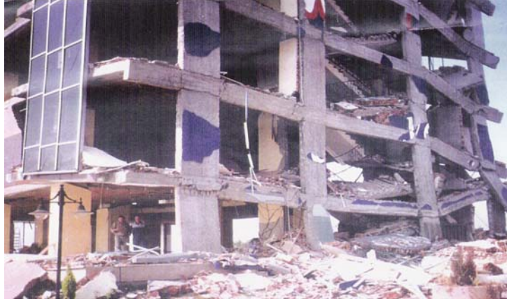
Şekil 2.15. Merdiven kovanından hasar görmüş bina (Çiftçi, 1999)
