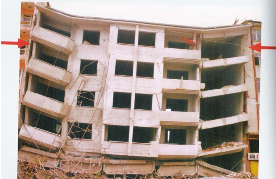
Şekil 2.11. Komşu binalardan dolayı hasar görmüş yapı (Çiftçi, 1999)
