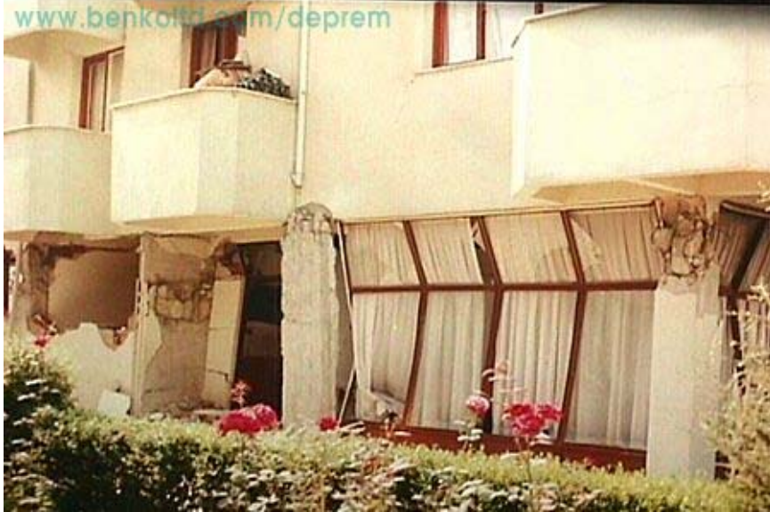
Şekil 2.20. Zemin kattaki kolonların depremde almış oldukları zararlar ( http://www.benkold.com/deprem/hareket_ani.htm )
